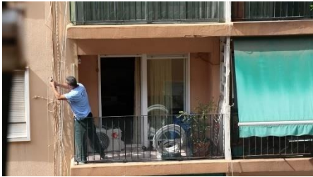
Imatge 20 Instal·lació del aire condicionat del meu veí des de la casa de mon pare
