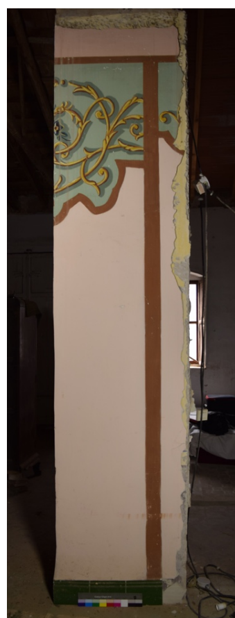
Img. 3: Fotografía general de la obra sobre el pilar, orientado hacia el sur.
