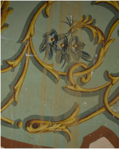
Img.43: Fotografía de detalle del rastro de escorrentías cubierto de polvo
