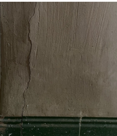
Img.45: Fotografía de detalle de una de las grietas estructurales.
