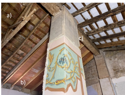
Img. 13: Primera planta, tejado reconstruido con diversos materiales tras el desplome en el año 2015:
