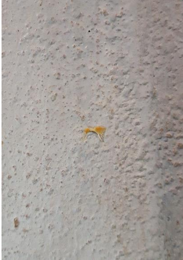
Figura 46. Suciedad superficial. Posibles restos de comida adherida.
