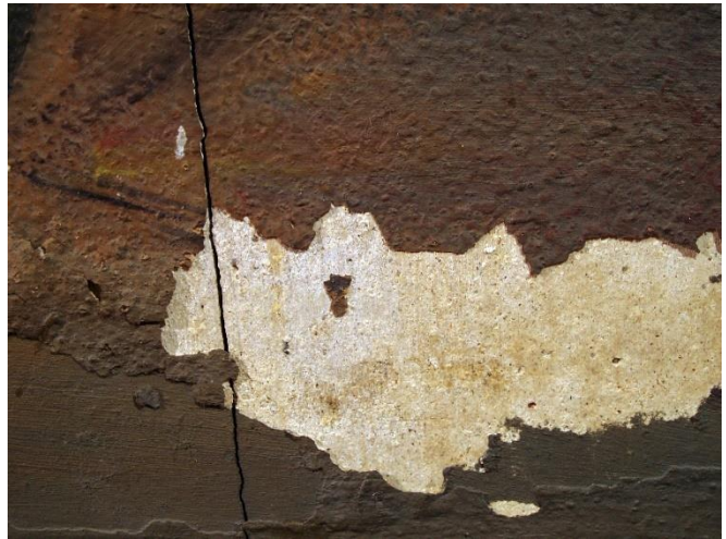
Figura 58. Primer plano de la grieta del muro y laguna.
