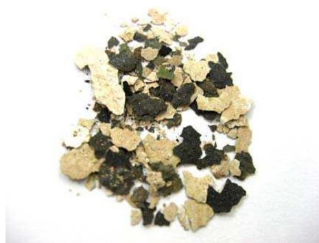
Figura 19. Fragmentos desprendidos de la superficie de la pintura.
