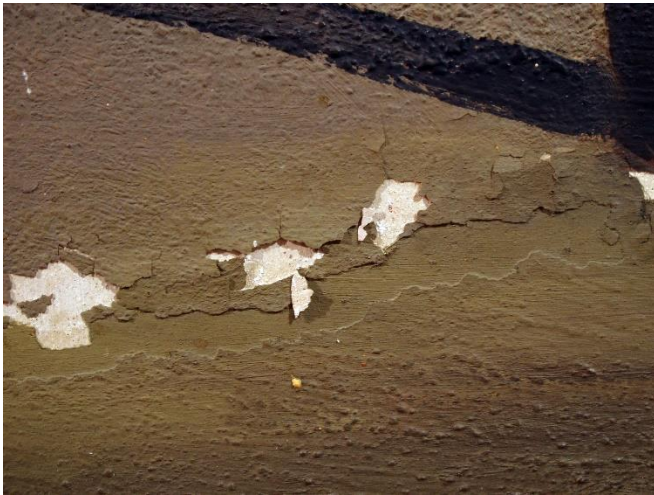
Figura 57. Fotografía del grave estado de desprendimiento que presentaba la pintura en algunas zonas.
