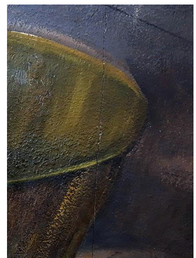
Figura 27. Grieta ascendente, 60-80 cm aprox.
