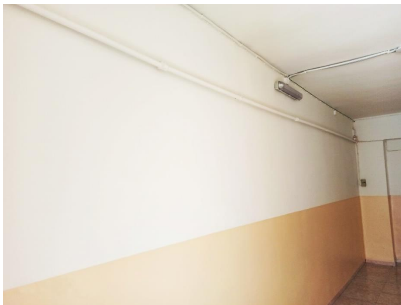
Figura 32. Instalaciones de la tubería del agua en el pasillo contiguo al comedor. Colegio San José Madres Escolapias, Valencia.
