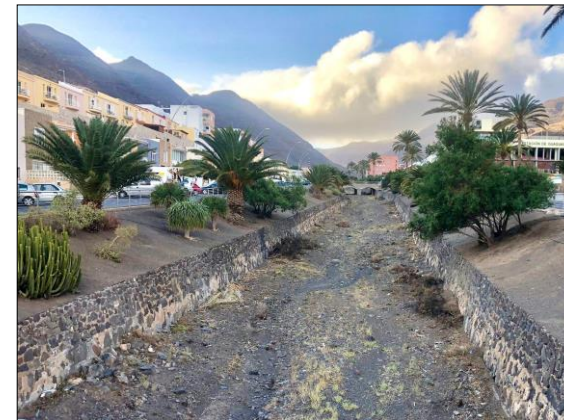
Ilustración 75. Drenaje longitudinal de Morro Jable. Fuente: propia.
