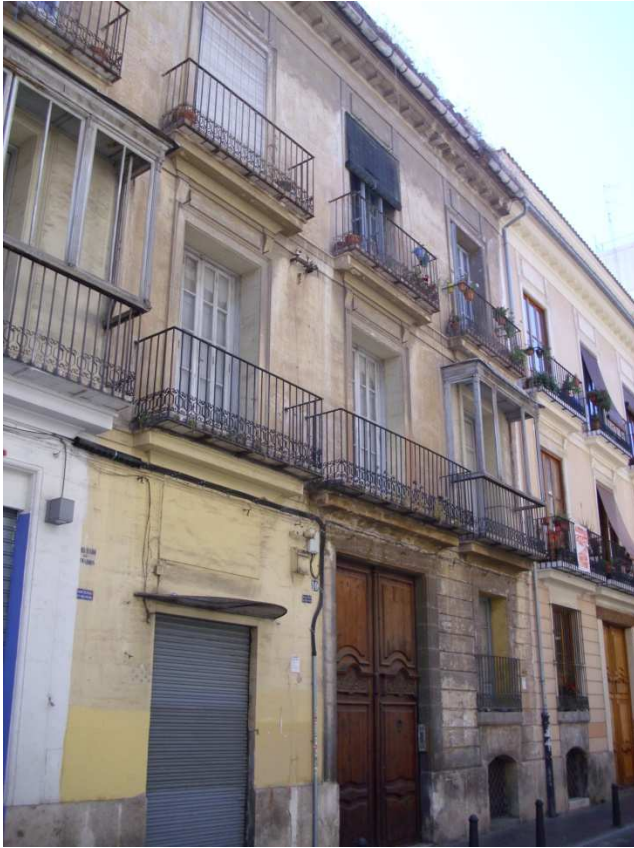
Imagen nº 23. Edificio en mal estado de conservación en c/ Guillem Sorolla. Junio 2012.
