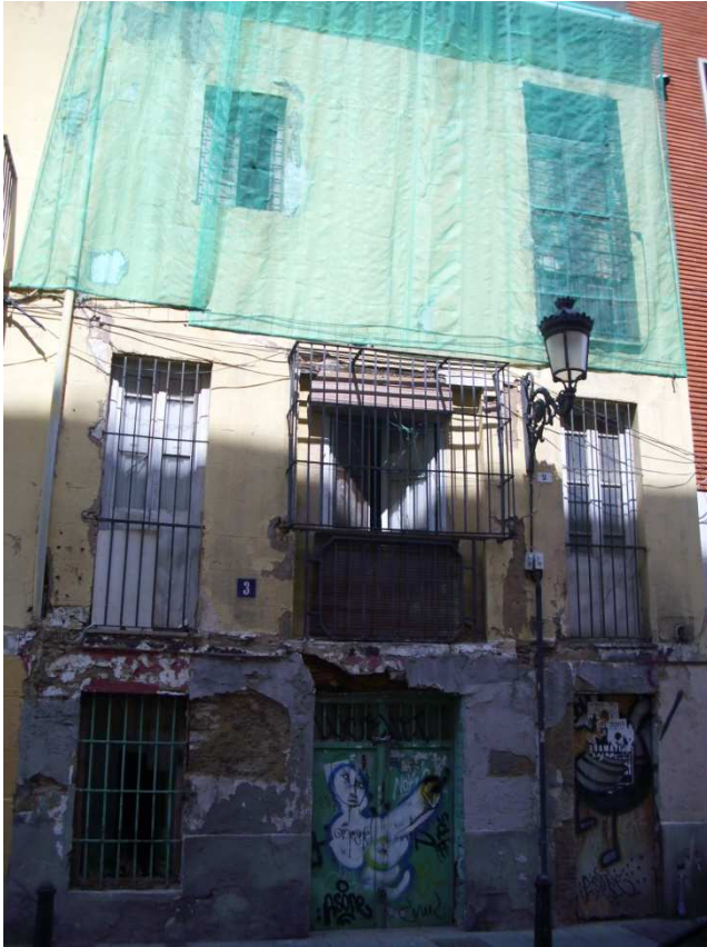
Imagen nº 19. Edificio en mal estado de conservación en c/ Arolas nº 3. Junio 2012.
