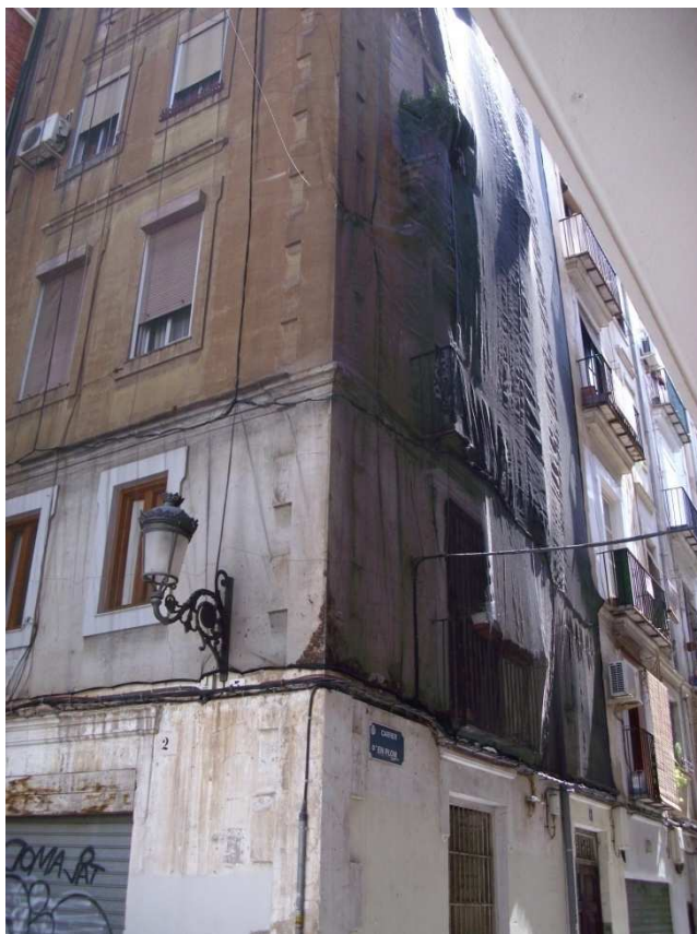
Imagen nº 22. Edificio en mal estado de conservación en c/ En Plom. Junio 2012.
