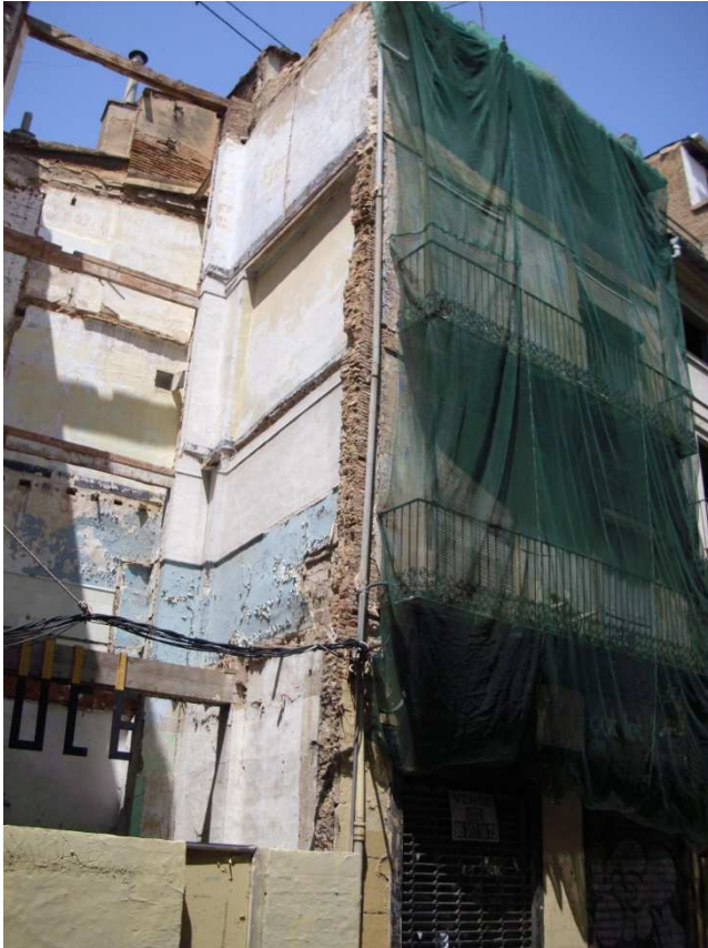
Imagen nº 25. Edificio en mal estado de conservación en c/ Bolsería. Junio 2012.
