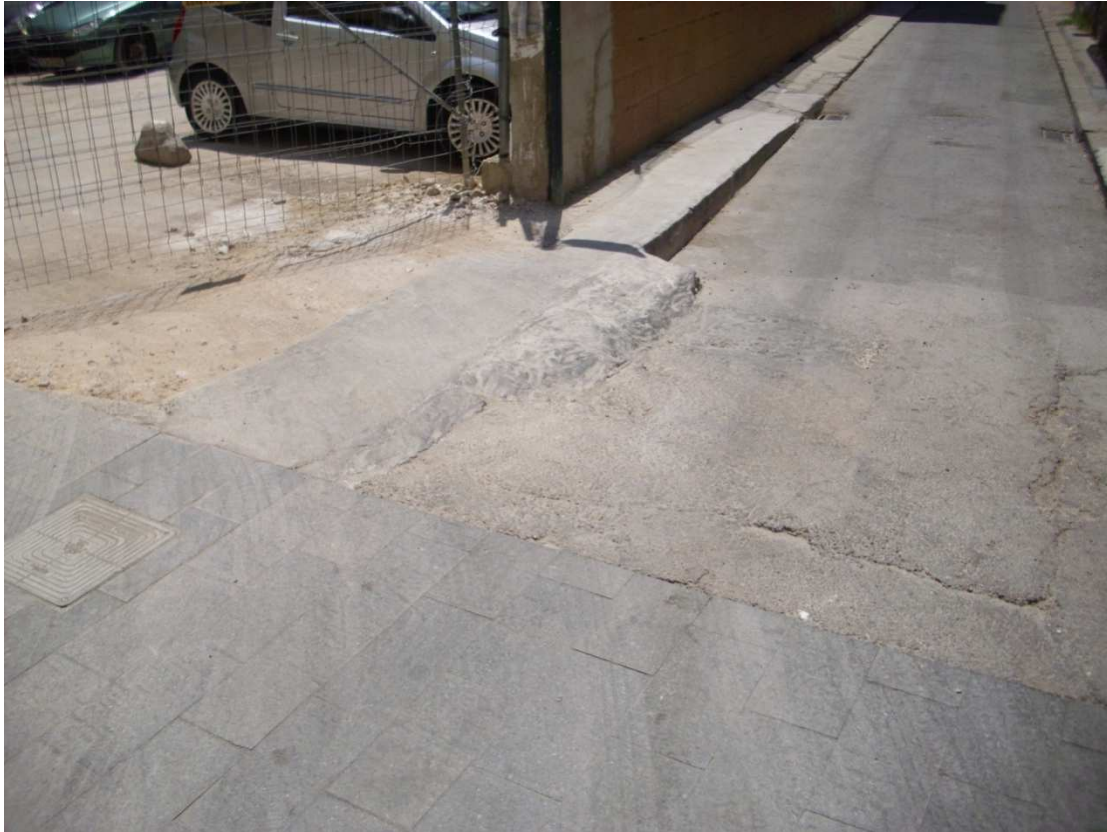
Imagen nº 109. Mal estado del pavimento de una calle. Junio 2012.
