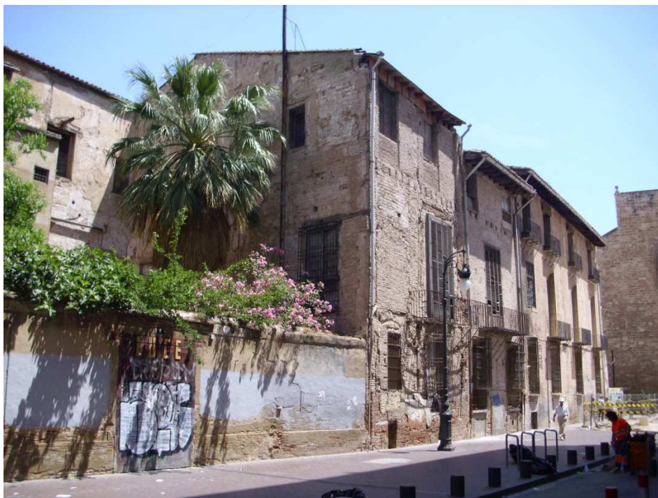
Imagen nº 29. Edificios en mal estado de conservación en la c/ Belluga. Junio 2012.
