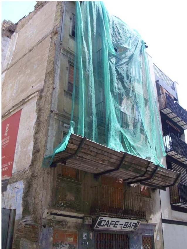
Imagen nº 21. Edificio en ruinas en c/ Murillo nº 36. Junio 2012.
