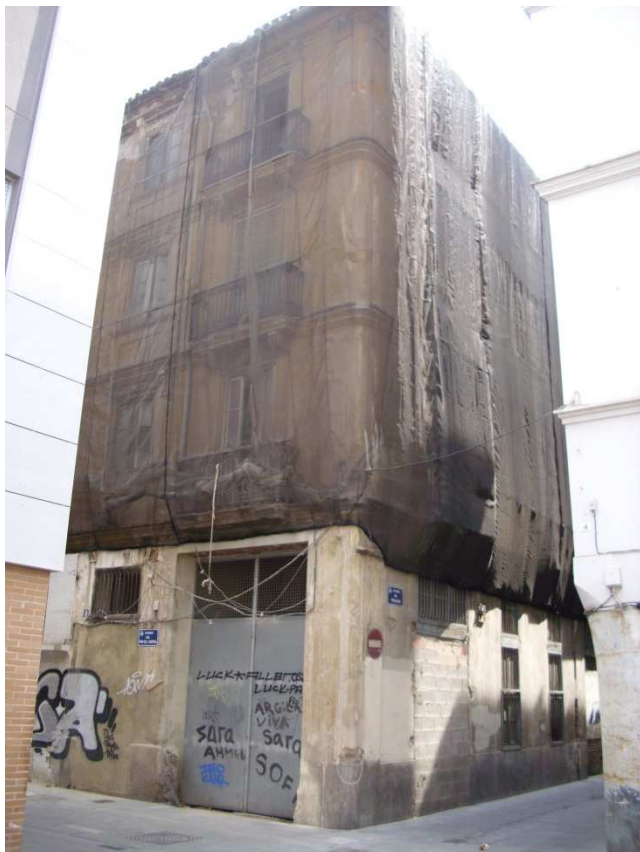
Imagen nº 18. Edificio en mal estado de conservación esquina c/ Triador con c/ Torn de l'Hospital. Junio 2012.
