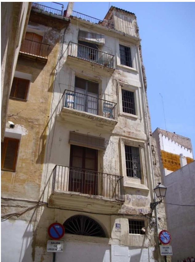
Imagen nº 28. Edificio en mal estado de conservación en c/ de Valencia. Junio 2012.
