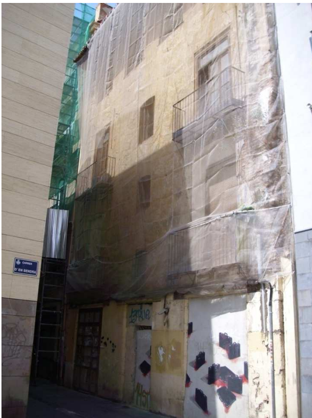
Imagen nº 20. Edificio en mal estado de conservación en c/ Lope de Rueda nº 13. Junio 2012.
