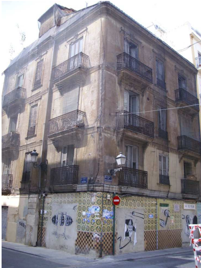
Imagen nº 17. Edificio en mal estado de conservación esquina c/ Recared con c/ Maldonado. Junio 2012.
