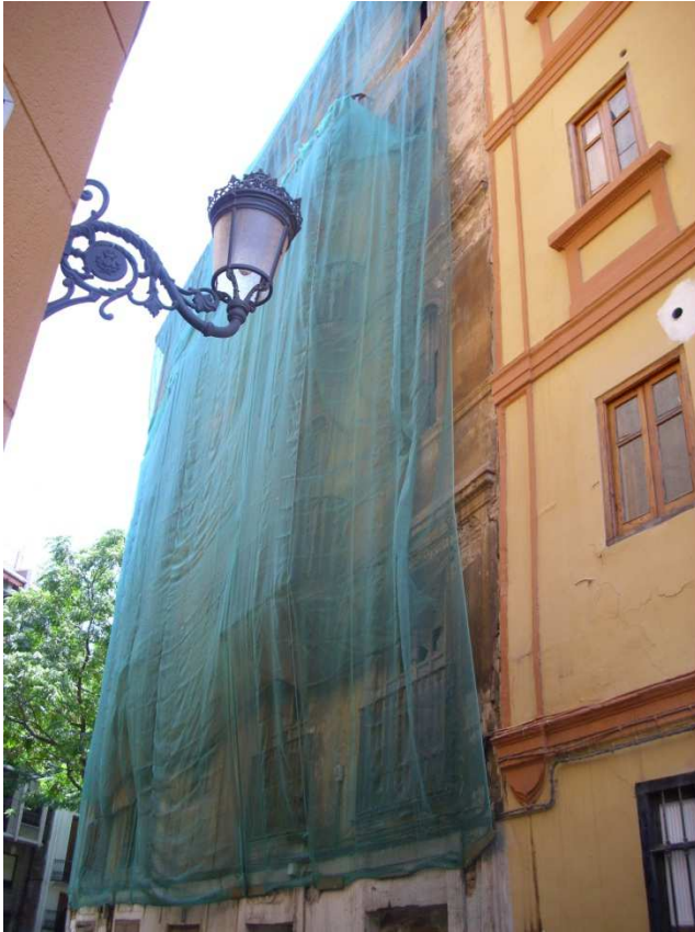
Imagen nº 27. Edificio en mal estado de conservación en c/ Sampedor. Junio 2012.
