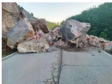
Fig. 6. Estela Ferrer. Derrumbamientos en la carretera secundaria TE-8215 (tramo Berge - Alcorisa)
