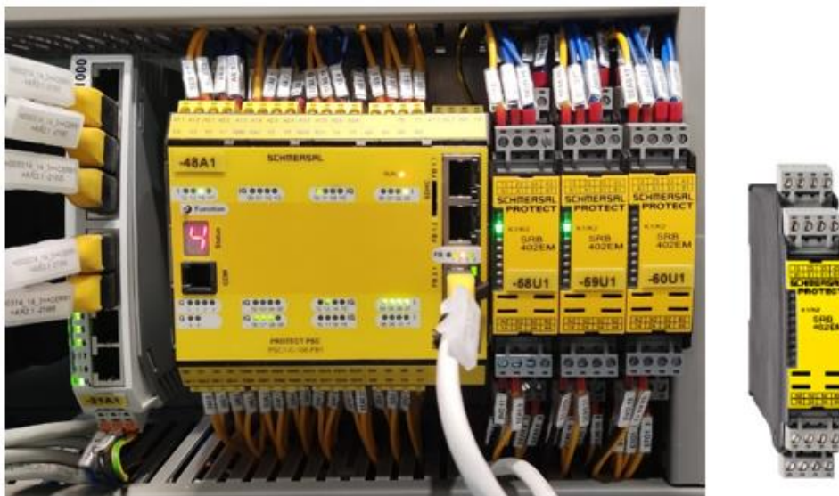
Figura 2: PLC Seguridad y expansores
