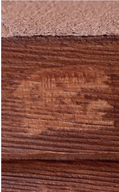
Figura 21. Impronta de una pegatina publicitaria sobre el barniz envejecido del acceso del primer piso.
