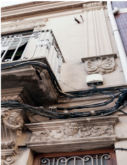
Figura 14 . Lavado diferencial por vertido de precipitaciones desde la escorrentía del balcón.
