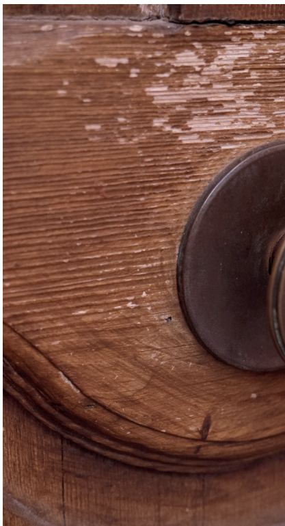
Figura 20. Erosión utilitaria alrededor del pomo del acceso del primer piso.
