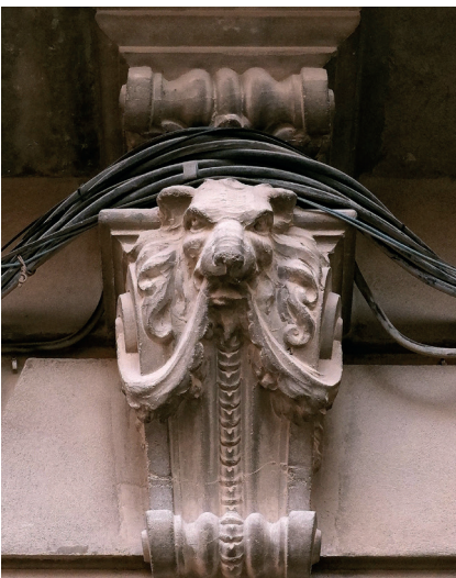
Figura 15 Detalle de una ménsula cubierta por un estrato de suciedad superficial.
