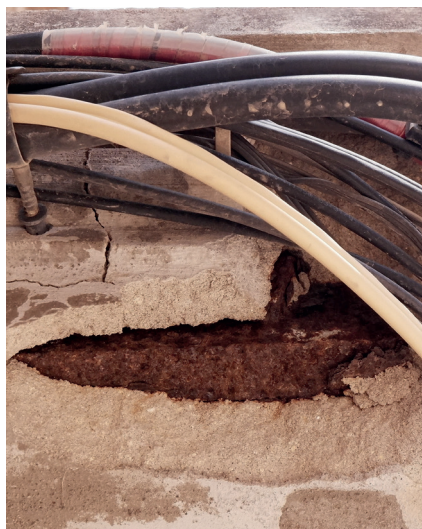
Figura 13. Desprendimiento por oxidación de elementos metálicos internos del voladizo del balcón.
