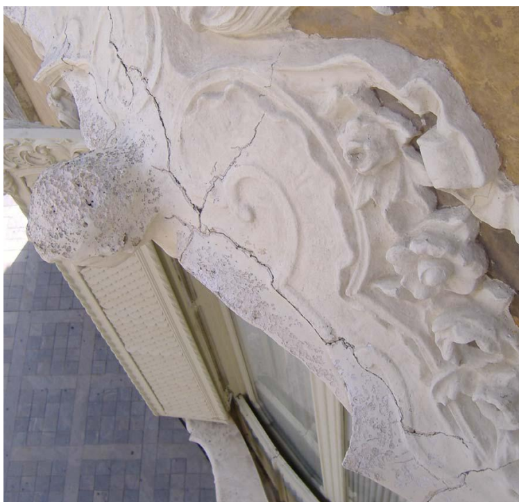
Figura 3.15 Estado de conservación de los cercados de hueco. Fuente: Memoria se obras de emergencia en fachadas del palacio del marqués de Dos Aguas
