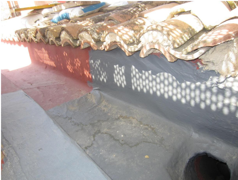
Figura 3.20. Detalle del estado actual entre la zona intervenida y la no intervenida en el canalón Fuente: Foto de la autora
