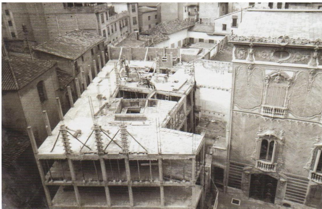
Figura 3.5. Fotografía de la construcción del edificio anexo al Palacio en el año 1965. Fuente: Archivo Museo Nacional de Cerámica. Valencia.
