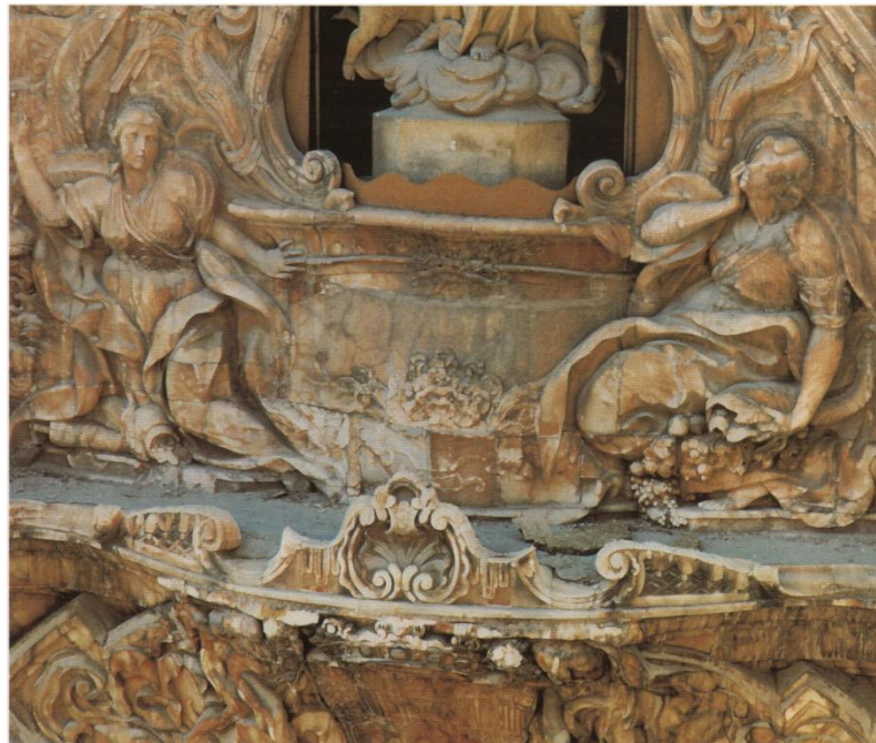
Figura 3.14. Fotografía del estado de conservación del vaso colmatado con mortero de cemento. Fuente: El Palacio de Dos Aguas. Claves de su restauración
