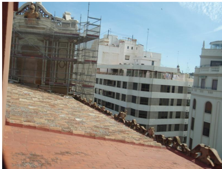
Figura 3.23. Fotografía del detalle del estado del torreón central. Fuente: Foto de la autora
