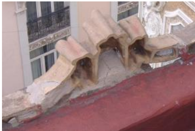
Figura 3.17. Estado de conservación de las piezas de terracota. Fuente: Memoria se obras de emergencia en fachadas del palacio del marqués de Dos Aguas
