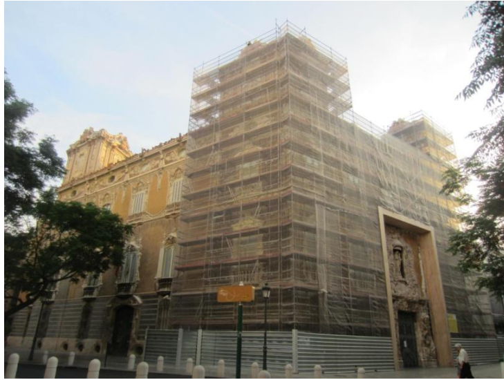
Figura 3.22. Fotografía del detalle del estado del torreón central. Fuente: Foto de la autora
