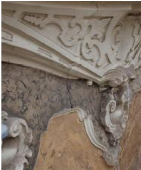
Figura 3.16. Estado de conservación de los estucos. Fuente: Memoria se obras de emergencia en fachadas del palacio del marqués de Dos Aguas
