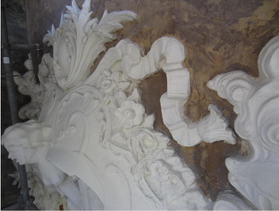
Figura 3.19. Estado actual de las molduras. Fuente: Foto de la autora
