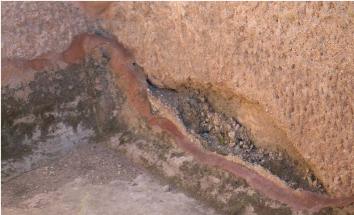
Cordon de sellado y revestimientos de morteros de cal “opus signinum” del vaso de la piscina del “Frigidarium”
