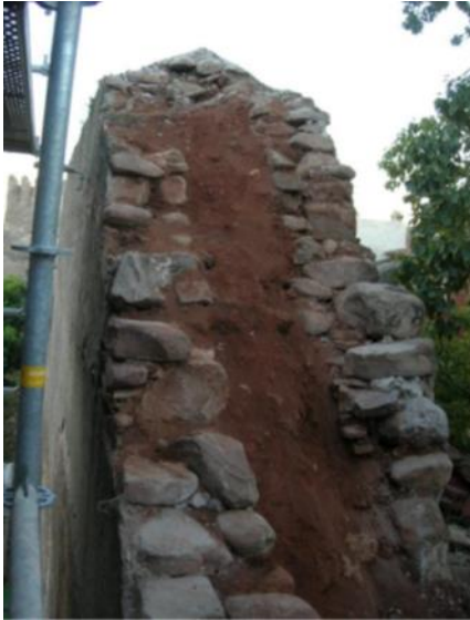
Figura 48: Sección de la tapia en la parte reconstruida en 1942 por Regiones Devastadas. Fuente: Enrique Íñiguez Rodríguez
