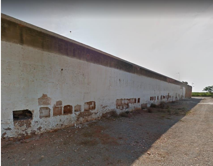
Figura 50: Estado de la muralla en zona sur después del cambio de ubicación del cementerio en los años 90. Fuente: Google maps.
