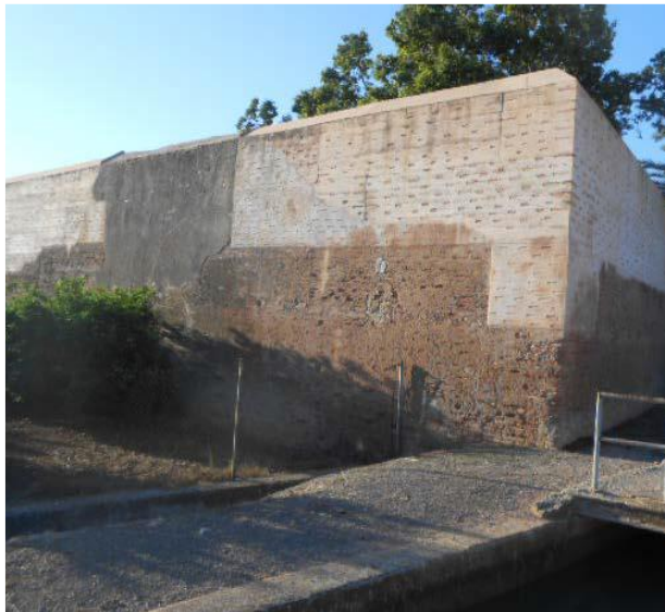
Figura 51: Zona del muro a noroeste donde se tapa la acequia en los años 60. Actualmente está relleno con tapial después de las obras de 2008. Fuente: Enrique Íñiguez Rodríguez
