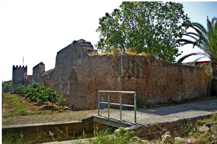
Figura 49: Zona del muro a noroeste donde se tapa la acequia en los años 60. Situación de la muralla tras las tormentas de 1987. Fuente: Enrique Íñiguez Rodríguez
