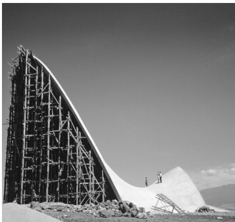
Fig. 27. Cimbreres de fusta suportant superfície de formigó en gran altura al Mèxic.
