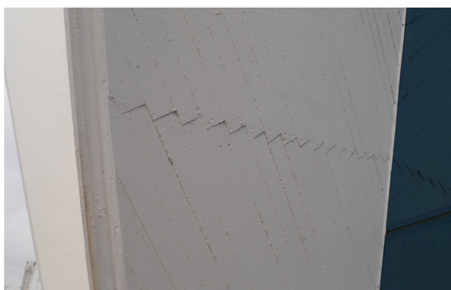
Fig. 35. Detall de la marca de l'encofrat a la superfície.
