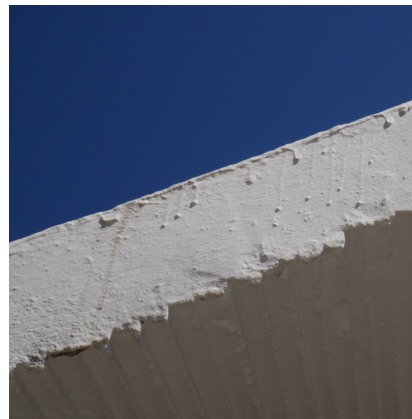
Fig. 116. Petjada de l'encofrat.
