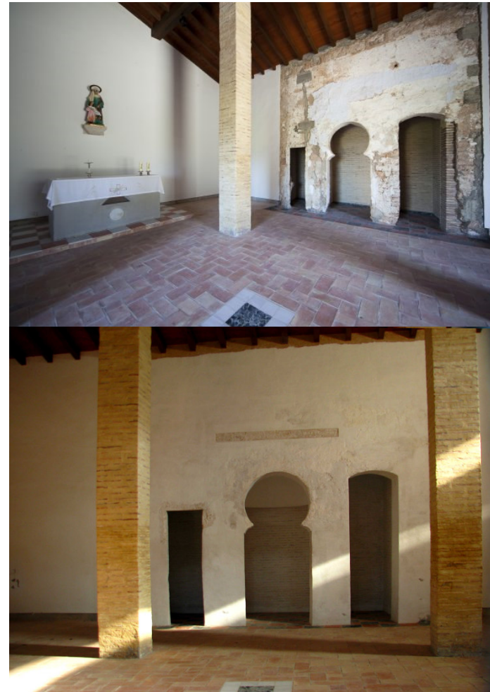
Fig.44. Muro con puertas que dan a las dependencias interiores. (arriba, antes de restauración; abajo, tras la restauración).
