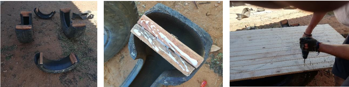
Ilustración 173: Unión de los neumáticos al tablero. Fuente: Propia
