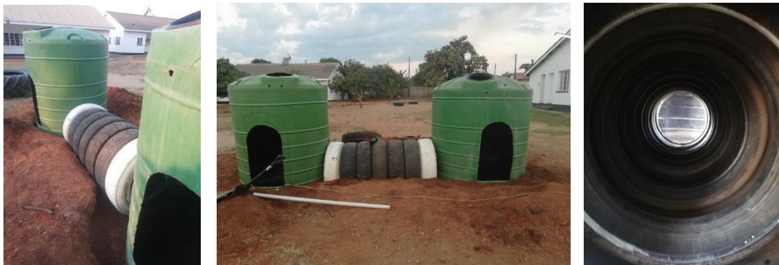
Ilustración 90: Instalación de túnel y casitas. Fuente: Propia
