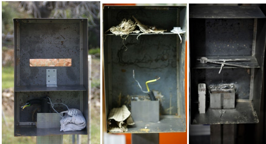
Il·lustració 241, interior de la caixa de l'Escomesa.
