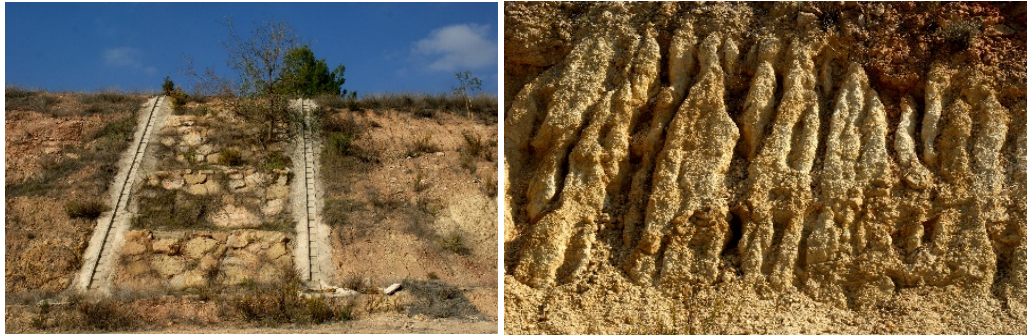
Il·lustració 237 i 238. Obres abandonades CV50. Detall del Talús Font pròpia
