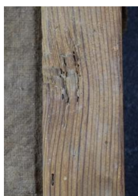
Fig. 32. a-b) Galerías causadas por insectos xilófagos.
