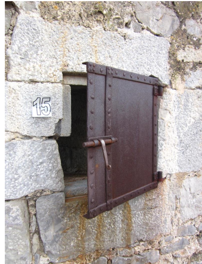
Fig. 36: Contraventana. Todas las troneras de la torre disponían de contraventanas de hierro como ésta, pero se han ido perdiendo con el tiempo. Ésta es original y la única que se conserva.
