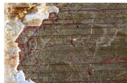
Fig. 30. Detalle de las pérdidas en todos los estratos, golpes y rayados.
