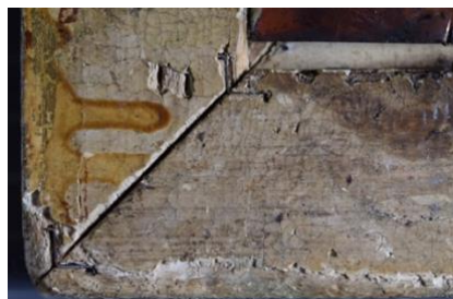
Fig. 27. Detalle de las grietas y pérdidas de materia por el reverso.
