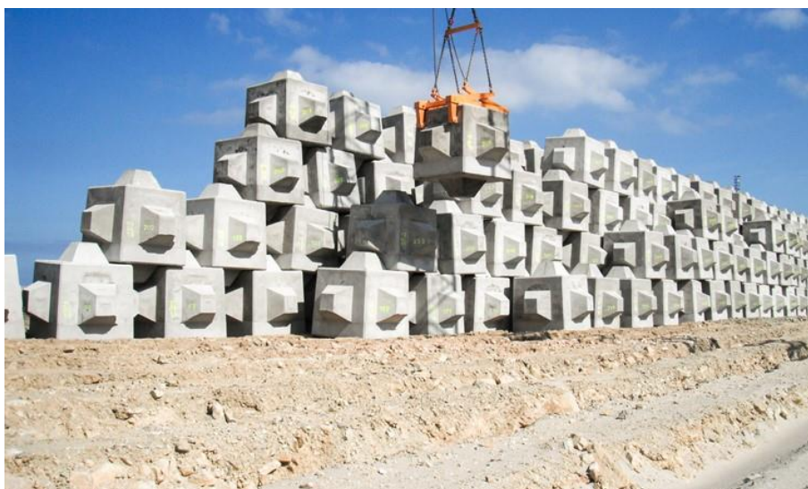
Figura 7.38. Acopio de Cubípodos. Fuente: Web del Cubípodo.
