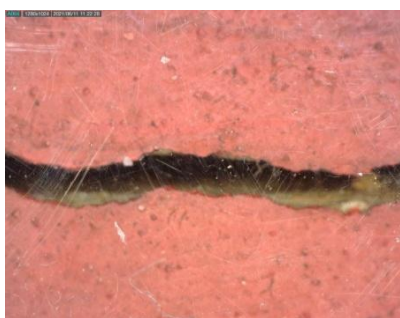
Figuras 65 y 66. Fotografías de microscopía óptica de las dos grietas estructurales.
