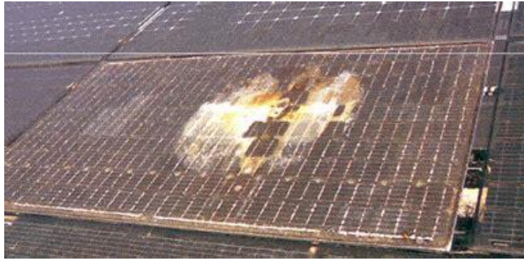
Ilustración 16. Daños por sobrecalentamiento en células fotovoltaicas.
