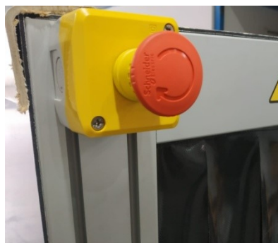
FIGURA13 -Parada de emergencia 2
