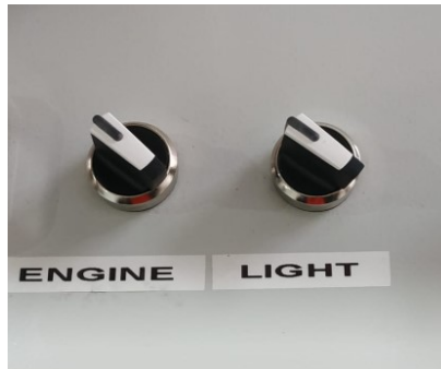
FIGURA11 -Interruptores de encendido y apagado
