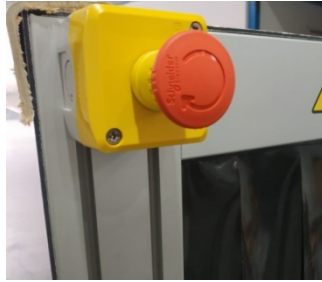
FIGURA 6 -Parada de emergencia 2
