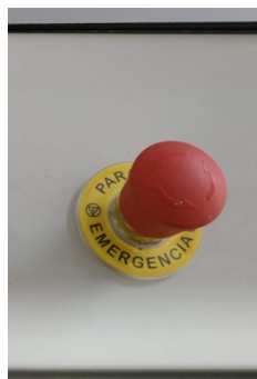
FIGURA5 -Parada de emergencia 1
