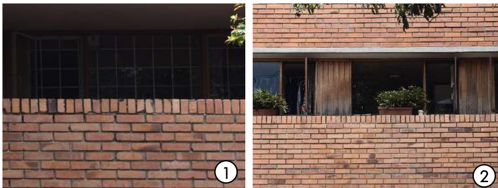
Figura 96. Fotografías detalle de patologías Conjunto Residencial El Polo. Edición: La Autora (2021).
