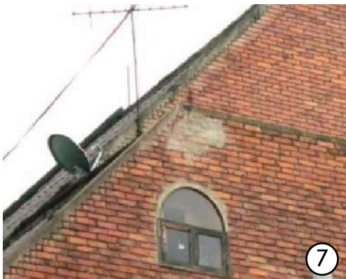
Figura 98. Fotografías detalle de patologías Fundación Cristiana San Cristóbal. Edición: La Autora (2021).
