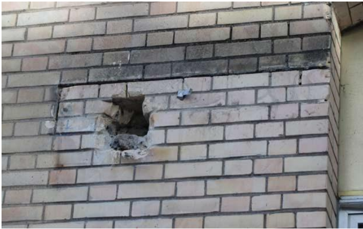
Ilustración 103, Fabrica dañada por apoyo mal ejecutado de techumbre
