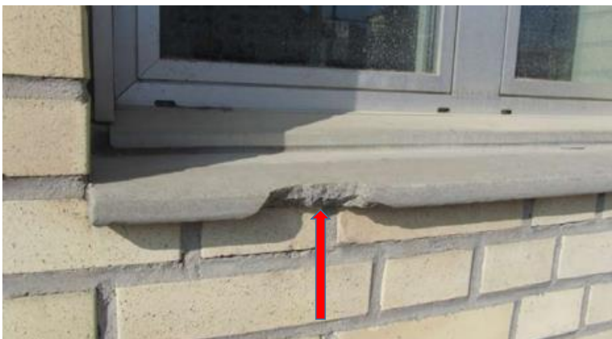
Ilustración 107, alfeizar dañado Fuente, Informe 03.04.2013, Müller & Truniger Arquitectos Zúrich
