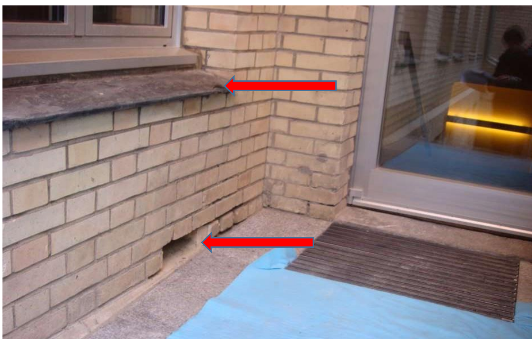
Ilustración 109, Fabrica incompleta y alfeizar deteriorado Fuente: Informe, 03.04.2013, Müller & Truniger, Arquitectos, Zúrich
