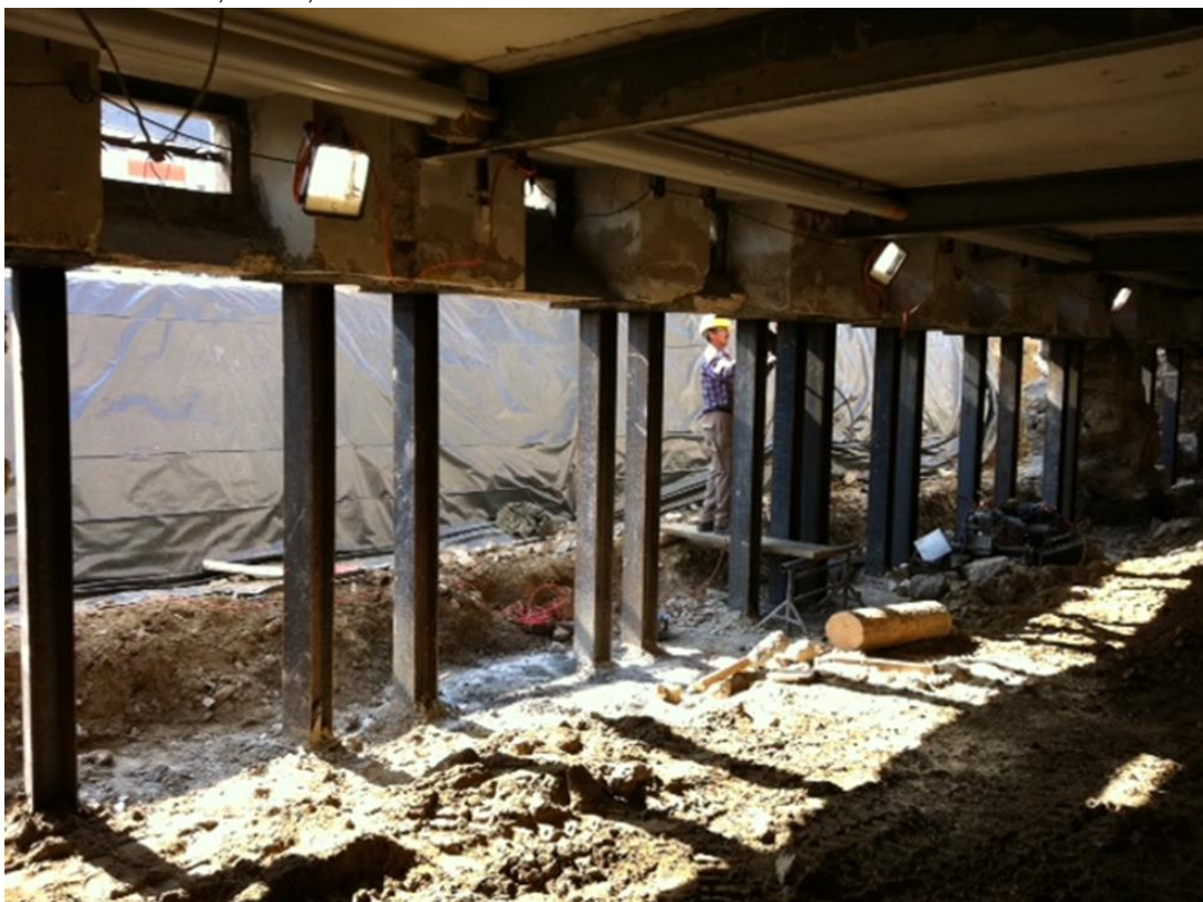
Ilustración 1256, eliminación del muro a introducción de línea de pilares Fuente: Archobau, Zúrich, dirección de obra
