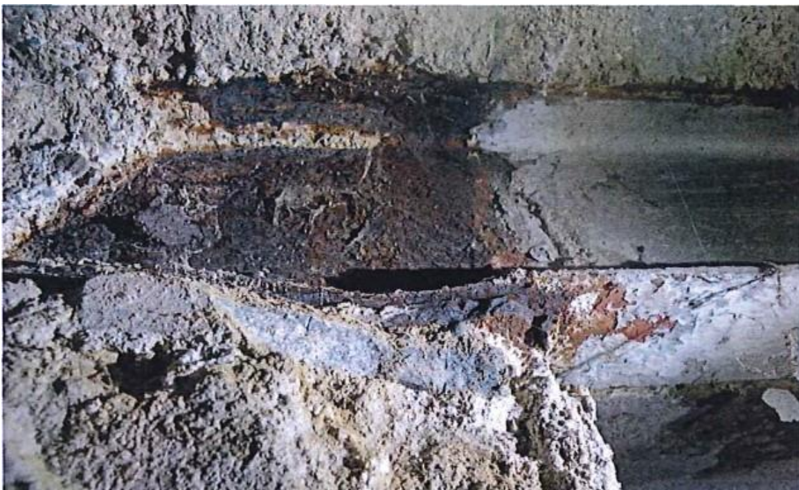
Ilustración 99, MFO, Detalle dintel ventana Fuente: Informe técnico 19. octubre 2011, Henauer & Gugler, Ingenieros, Zürich
