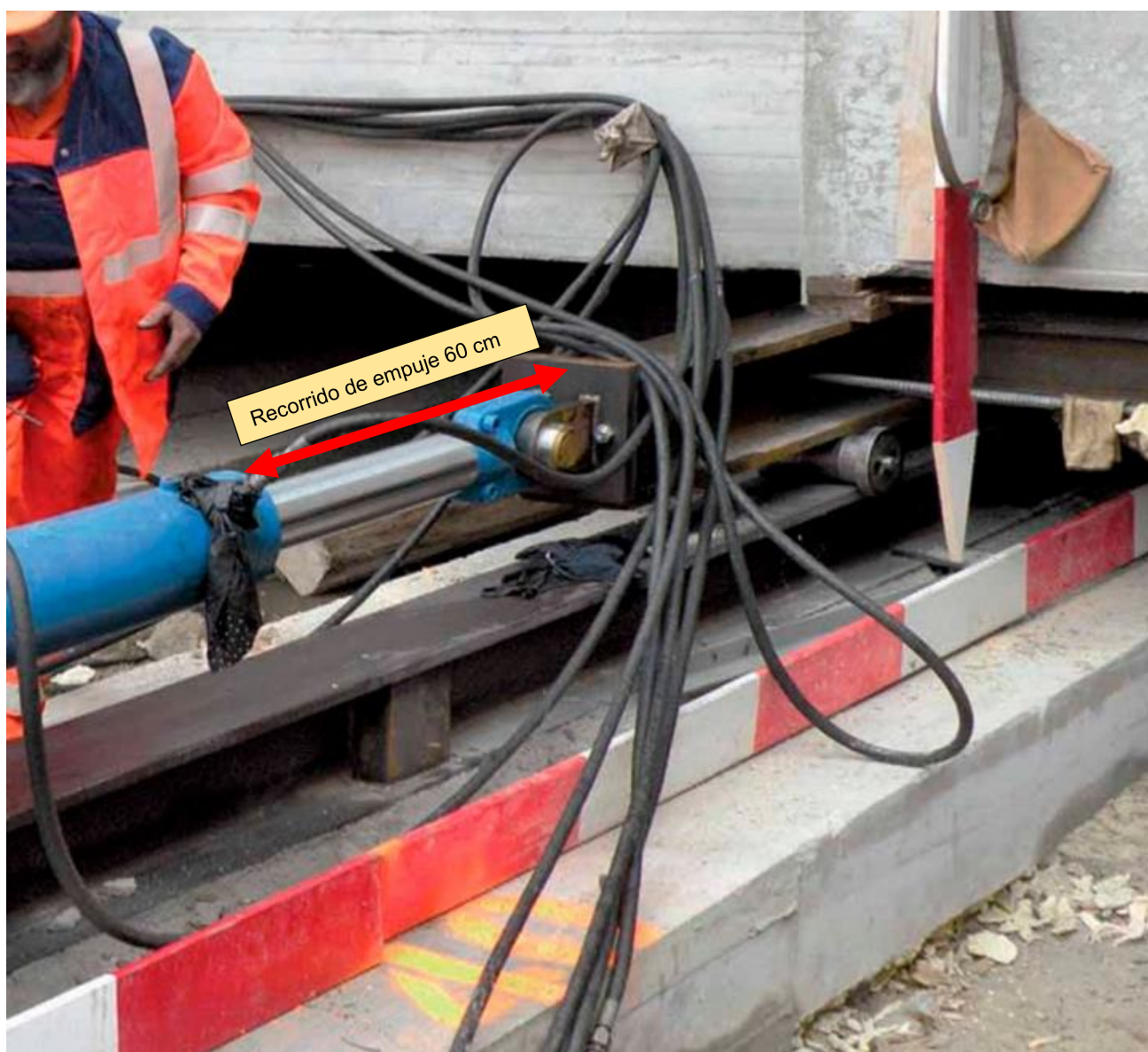
Ilustración 170, recorrido de la prensa de empuje horizontal Fuente: Henauer & Gugler, Ingenieros, Zúrich
