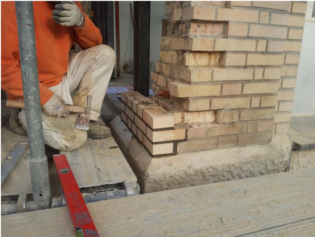
Ilustración 114, Recomposición de muro de ladrillo cara vista Fuente: Archobau, Zúrich, dirección de obra
