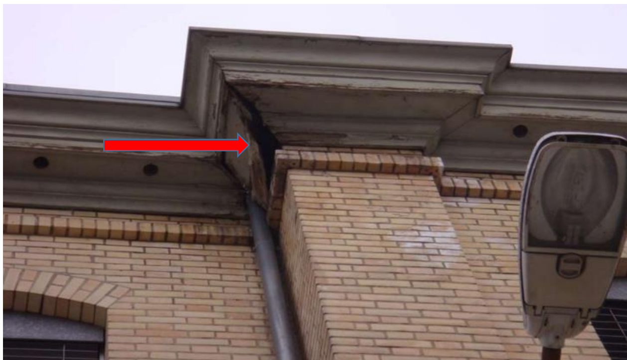
Ilustración 106: Cornisa, voladizo en madera dañada por filtraciones de agua Fuente: Informe, 03.04.2013, Müller & Truniger, Arquitectos, Zúrich
