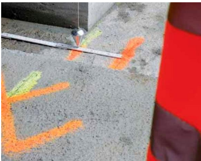
Ilustración 174, punto de control / edificio en emplazamiento nuevo. Fuente: Archobau, Zürich, dirección de obra
