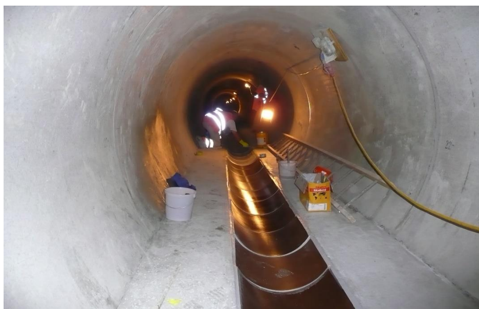
Ilustración 88, Conducto municipal de aguas residuales Fuente: Henauer & Gugler, Ingenieros Zúrich
