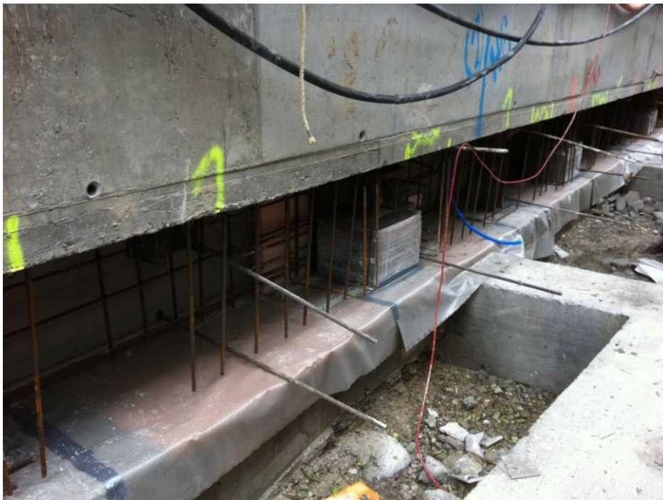
Ilustración 190, parte inferior de las vigas puente, listas para hormigonar Fuente: Henauer & Gugler, Ingenieros Zurich
