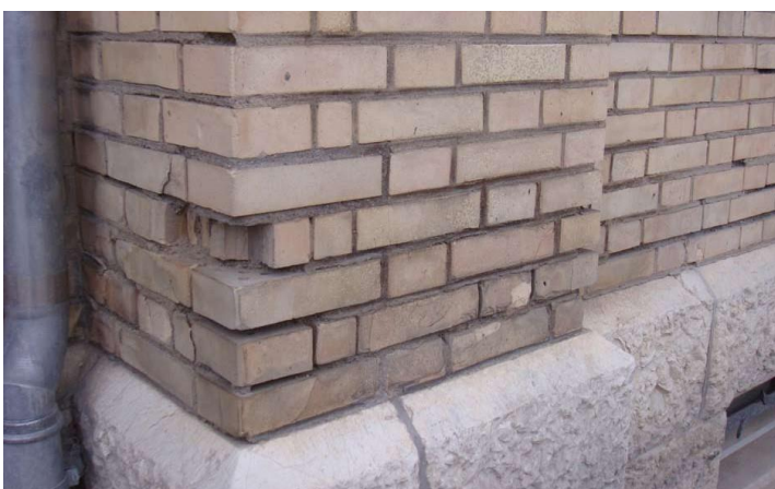
Ilustración 105, Fabrica dañada en pilares revestidos
