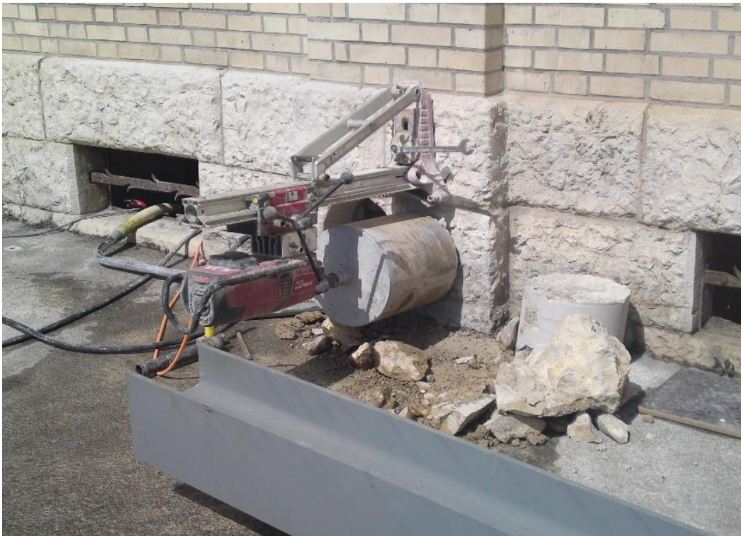
Ilustración 133, Perforación de fachada para la introducción de viga Fuente: Archobau, Zúrich, dirección de obra
