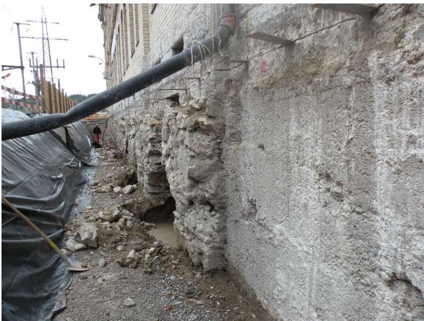
Ilustración 118, desvío de aguas pluviales Fuente: Jäckli Geologie, Ingenieros, Zürich
