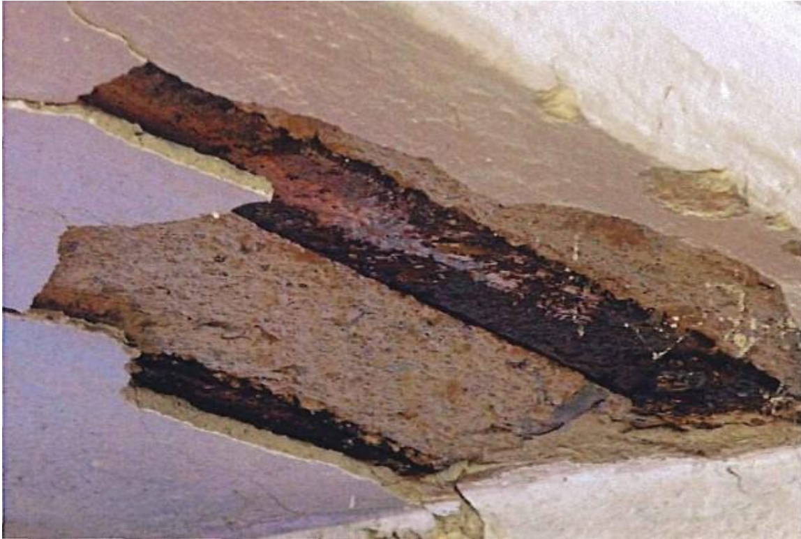
Ilustración 98, viga con corrosión y enfoscado desprendido Fuente: Informe Henauer & Gugler Ingenieros, 19.10.2011
