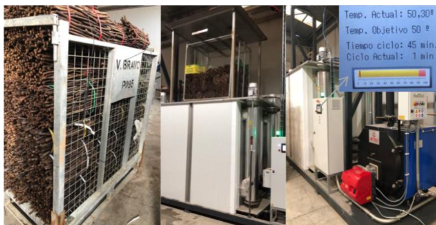
Imagen 3. Aplicación del tratamiento con agua caliente (termoterapia) en las instalaciones de Viveros Enrique Bravo S.L situadas en el municipio de La Pobra del Duc (Valencia).
