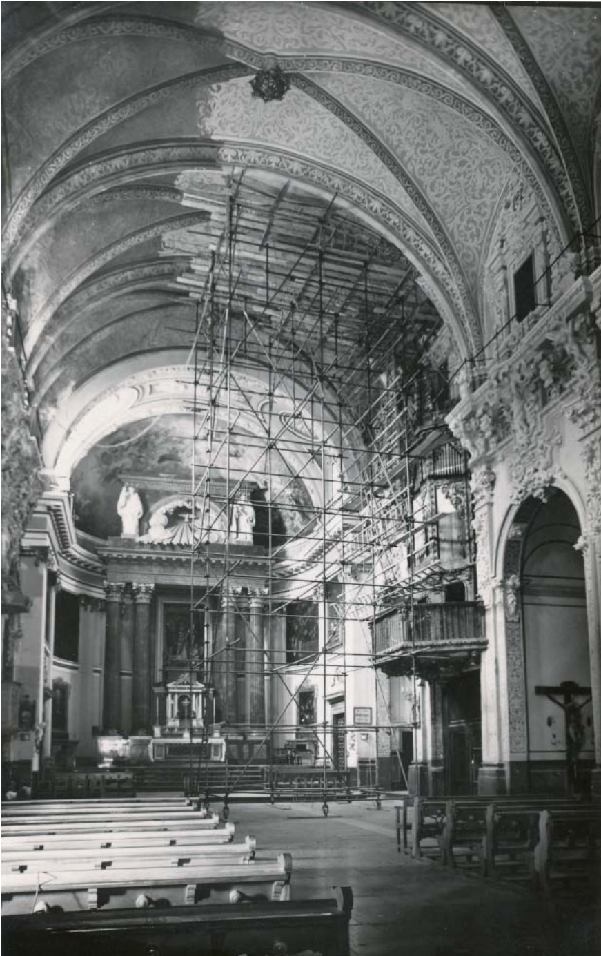
Figura 13.- Vista general durante el proceso de restauración en la iglesia de San Esteban de Valencia.
