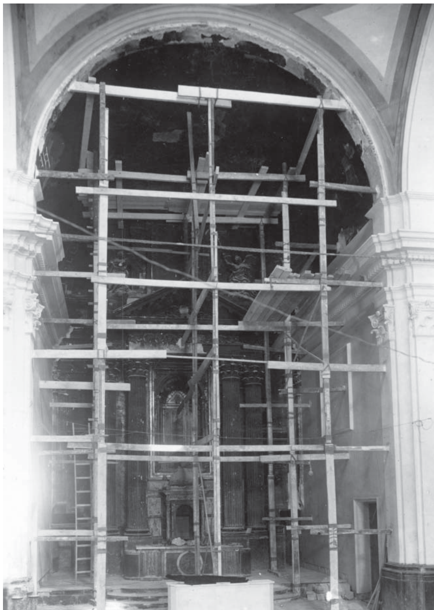
Figura 6.- Vista del andamio instalado para el acceso a las pinturas del presbiterio.
