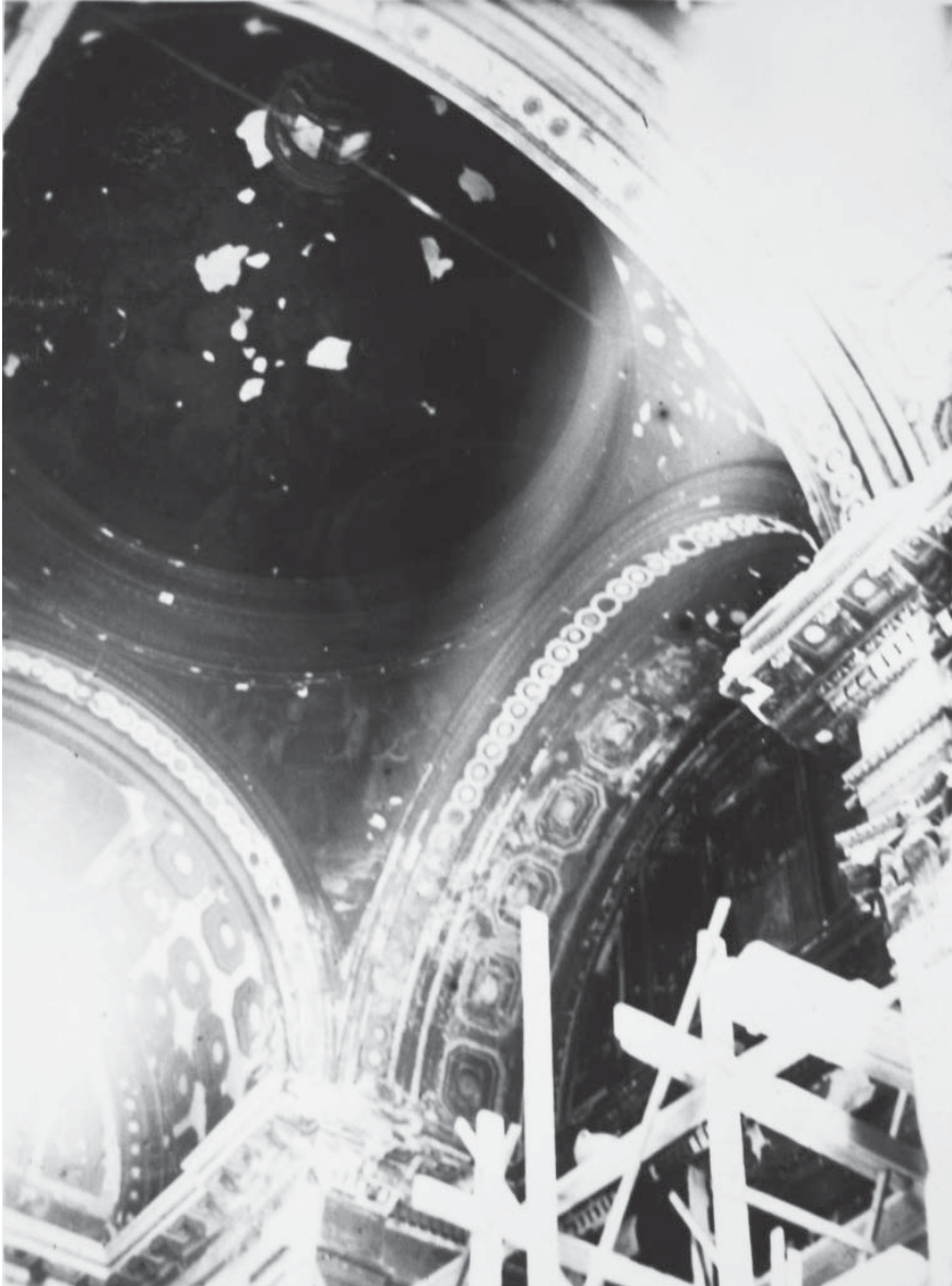
Figura 26.- Estado de conservación en el que se encontraba la cúpula de la Capilla de la Comunión tras el incendio de 1936.
