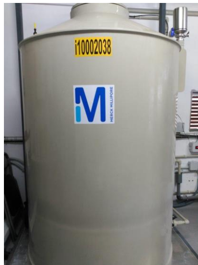
Figura 25. Tanc de distribució 2 (Imatge pròpia, 2021).
