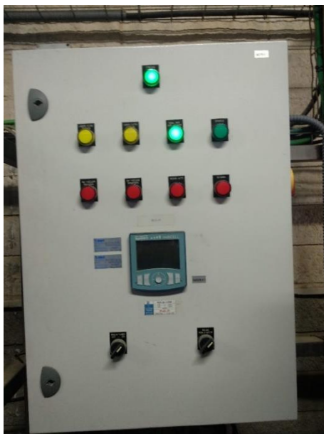
Figura 15. Panell de control i mesura del potencial REDOX (Imatge pròpia, 2021).
