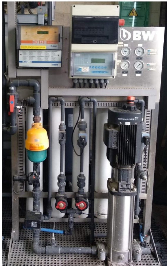
Figura 20. UOCL, Equip d'osmosi inversa (Imatge pròpia, 2021).
