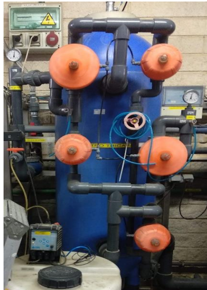
Figura 11. Filtre tri-capa instal·lat a la planta de pretractament (Imatge pròpia, 2021).
