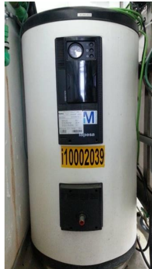
Figura 24. Caldera del dipòsit/ llaç de distribució 1 (Imatge pròpia, 2021).
