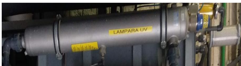
Figura 17. Llum UV instal·lat a la planta de pretractament (Imatge pròpia, 2021).
