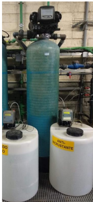
Figura 14. Filtre de carbó actiu instal·lat a la planta de pretractament (Imatge pròpia, 2021).
