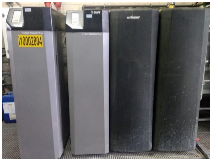
Figura 16. Equip de producció i emmagatzematge d'aigua RO instal·lat a la planta de pretractament (Imatge pròpia, 2021).
