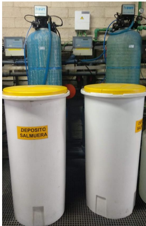
Figura 13. Columnes descalcificadores instal·lades a la planta de pretractament (Imatge pròpia, 2021).
