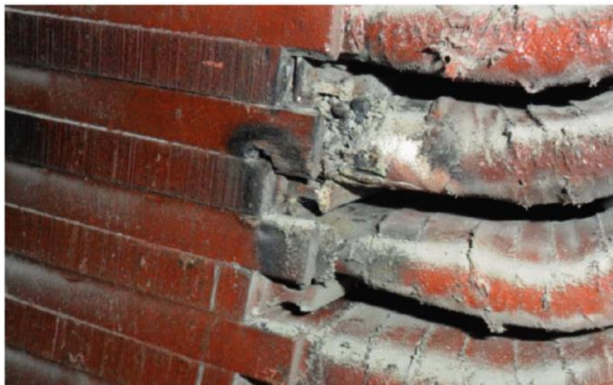
Figura 40. Aislamiento quemado por descarga en la zona de salida de la ranura caso práctico. [32]
