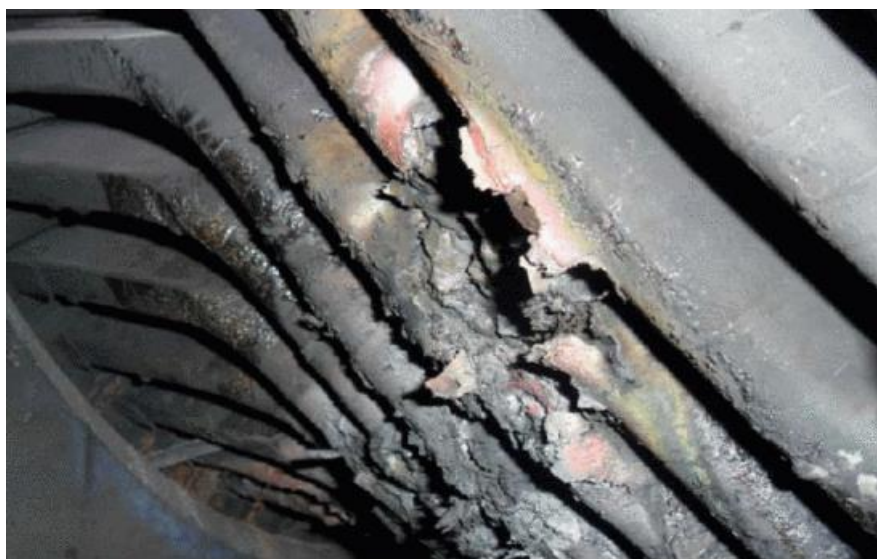
Figura 41. Aislamiento quemado por descarga barra-barra caso práctico. [32]
