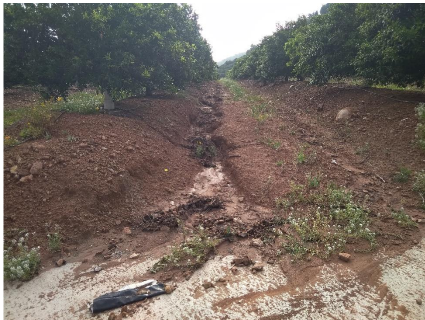
Figura 1. Erosión causada por lluvias torrenciales en una calle de mandarinos en la provincia de Valencia, donde la cubierta vegetal era escasa.
