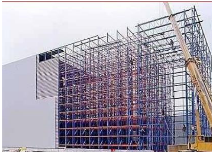
Ilustración 9 - Almacén autoportante Fuente: (Cardós Carboneras, 2019)
