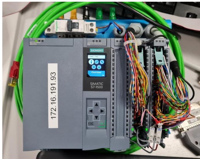
Ilustración 19. PLC Siemens S7 1500 (Fuente: Elaboración propia)
