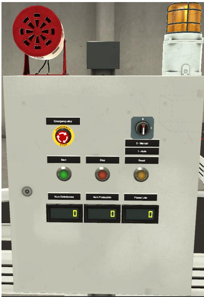
Figura 2. 24. Cuadro eléctrico con operadores de Factory I/O .
