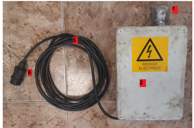
Imatge 2 Components Exterior Node
