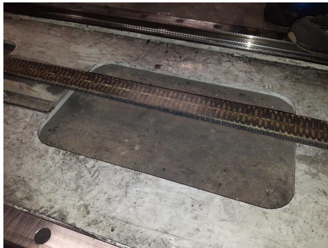
Figura 41. Sistema de transmisión de traslación. En la foto tomada en la célula de almacenaje, se observa en uno de los sistemas de traslación de la mesa de indexado, que la correa colisiona entre sí.
