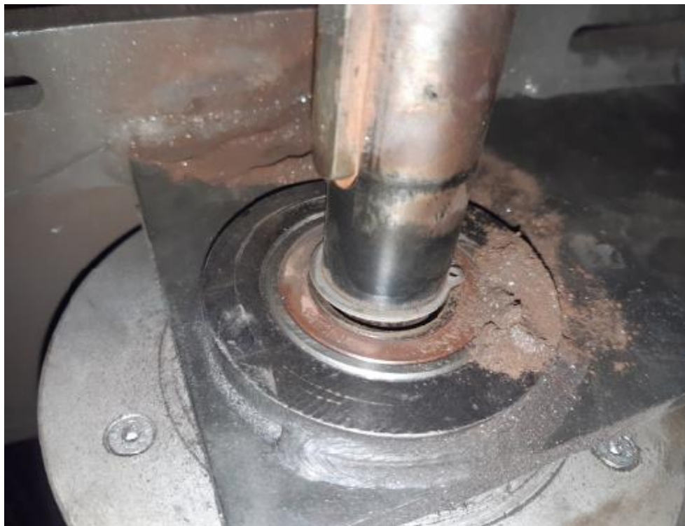
Figura 60. Desgaste entre árbol y rodamiento. En la foto tomada en el almacén se puede observar el material desgastado en el árbol motriz.
