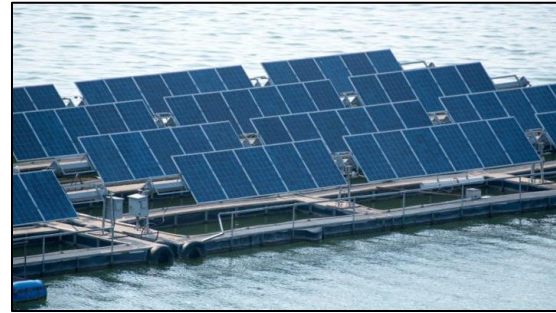
Figura 3. Sistema con Flotadores y Estructura Metálica
