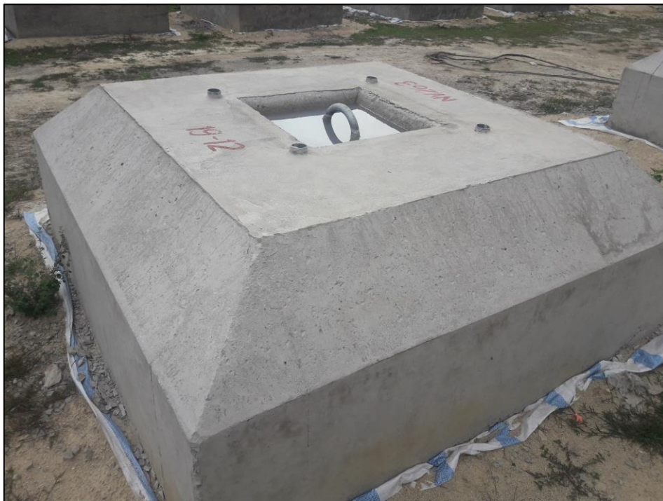
Figura 42. Contrapeso de Hormigón Armado
