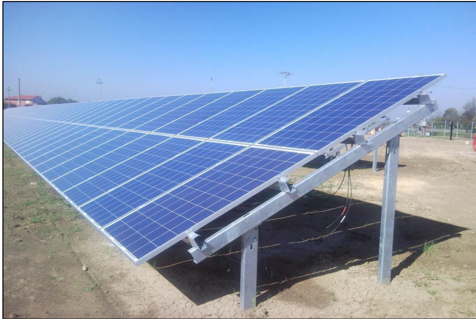
Figura 54. Estructura Soporte Paneles FV Biposte
