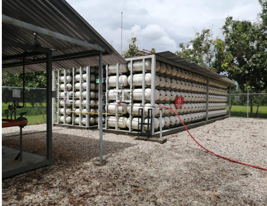
Figura 12. Canastillas de almacenamiento de GNC.
