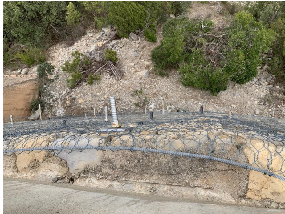
Ilustración 36 Patología típica del muro de mampostería: panzas. Fuente: Elaboración propia.
