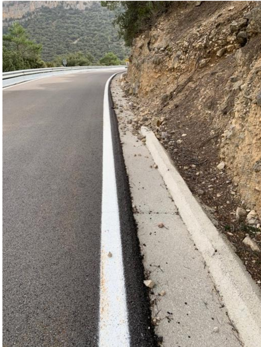
Ilustración 16 Bordillo de contención inexistente. Fuente: Elaboración propia.
