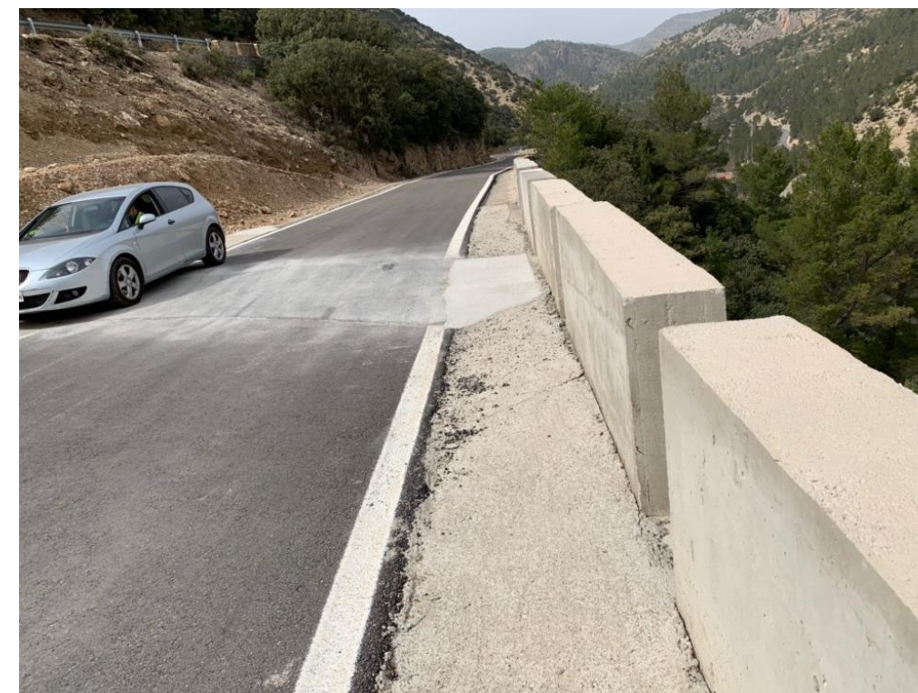
Ilustración 32 Trazado de la zona afectada. Fuente: Elaboración propia.
