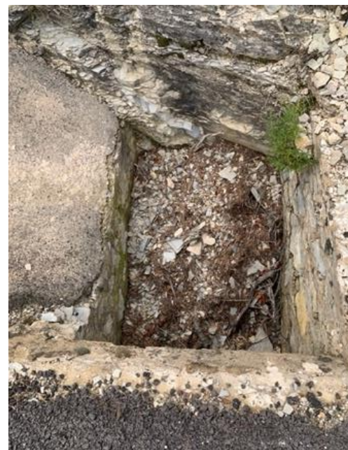
Ilustración 19 ODT con gran acumulación de sedimentos. Fuente: Elaboración propia.
