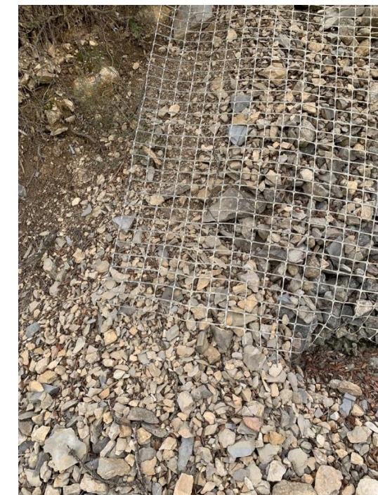
Ilustración 45 Rotura de la maya por exceso de peso. Fuente: Elaboración propia.
