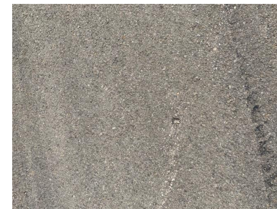
Ilustración 26 Estado del firme. Fuente: Elaboración propia.
