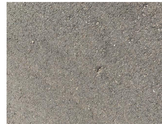
Ilustración 25 Estado del firme. Fuente: Elaboración propia.
