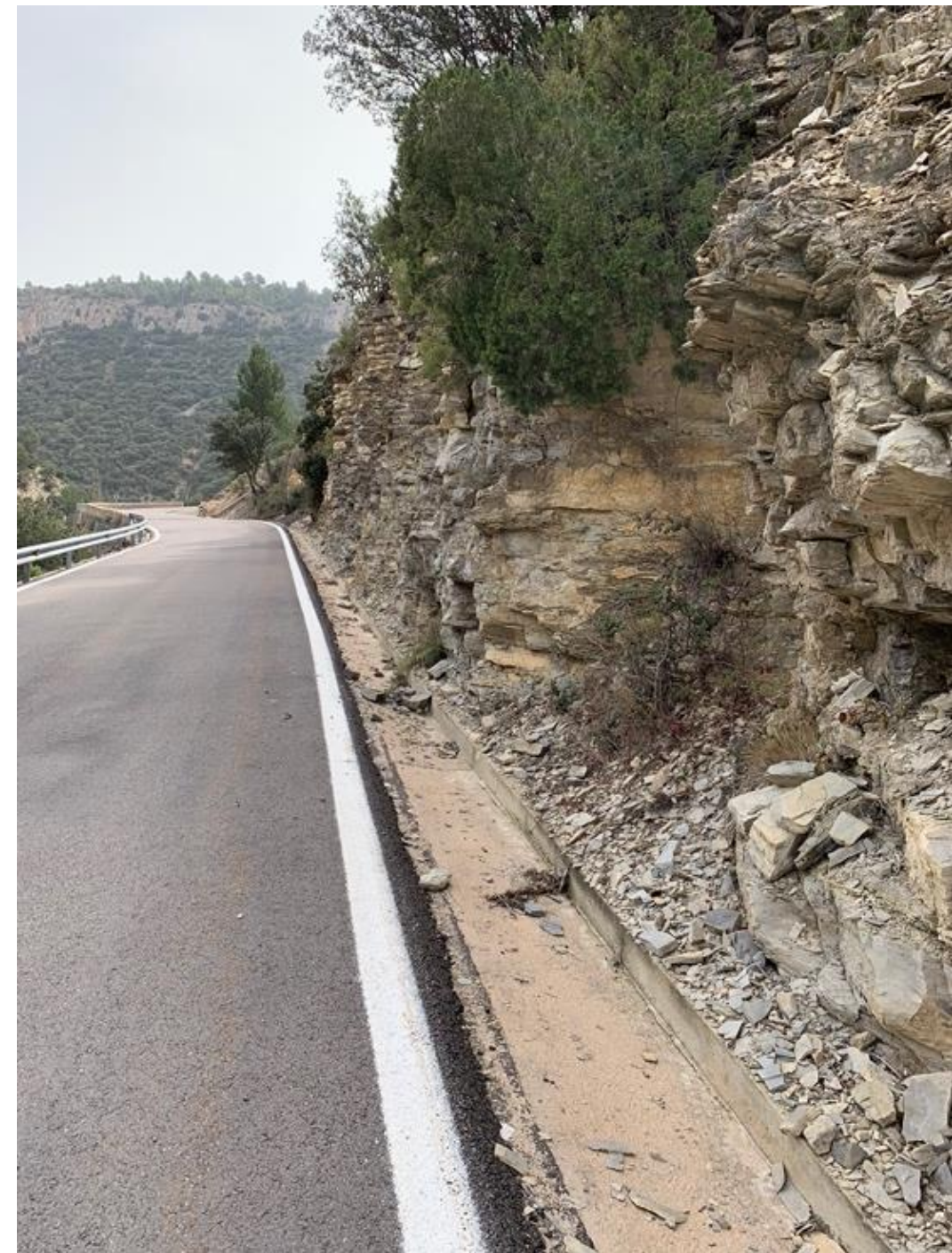
Ilustración 15 Cuneta ocupada por fragmentos de roca. Fuente: Elaboración propia.
