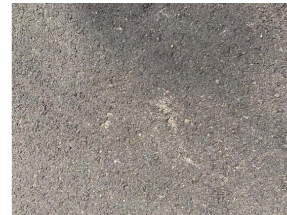
Ilustración 24 Estado del firme, punzonamiento. Fuente: Elaboración propia.
