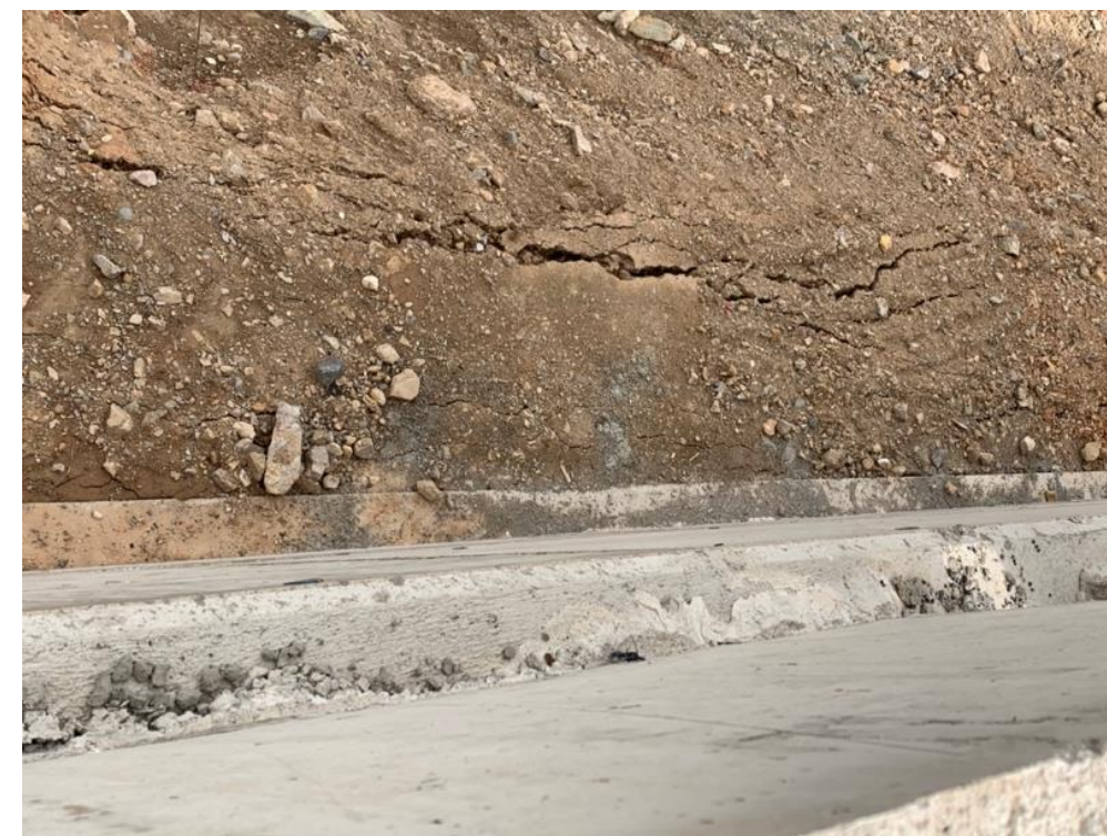
Ilustración 31 Grietas de tracción al pie del muro. Fuente: Elaboración propia.
