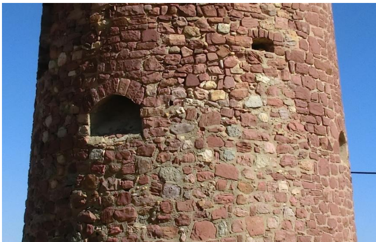
Detalle de la torre del Puig, donde se observa el material empleado.
