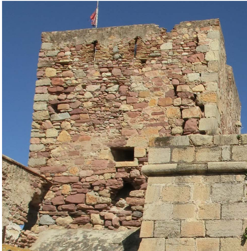
Foto de una fachada de la torre Grao Vell donde se puede ver los diferentes materiales utilizados, las distintas dimensiones de mampuestos, sillares y ladrillo.
