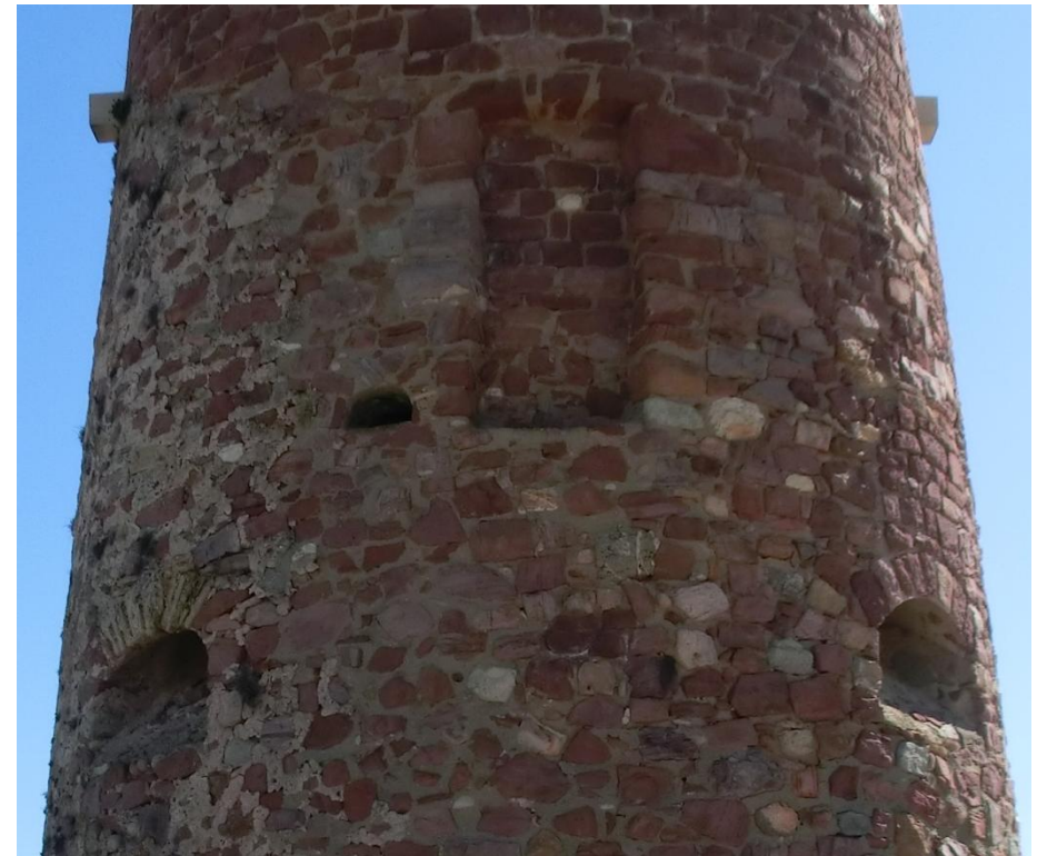
Detalle donde se ve la puerta de acceso superior tapiado, las troneras en los laterales de las puertas y una de las pequeñas ventanas.
