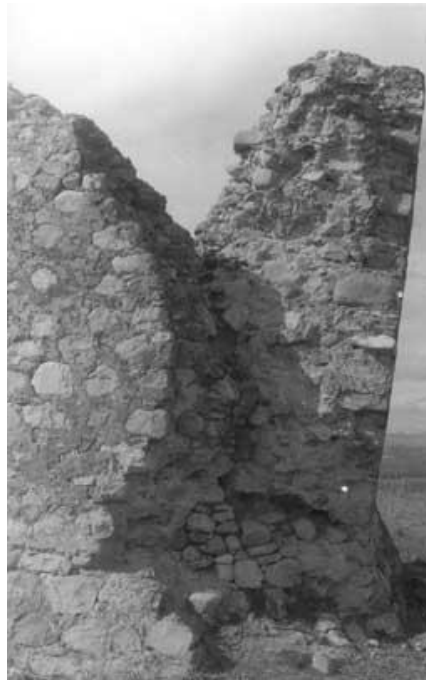
Foto de la torre de Biesma en 1979, donde se ve los muros con su inclinación hacia el exterior. Fuente: http://homepage.ntlworld.com/forcada/
