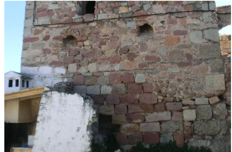
Foto de una fachada de la torre Grao Vell donde se puede ver las diferentes mamposterías, concertada en la parte inferior y ordinaria en la parte superior y los restos del muro de mampostería de la escalera.
