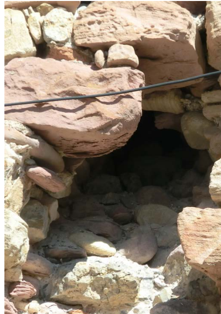
Zona derruida de muro de planta baja donde se ve el terrapieno.
