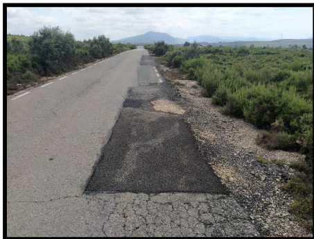
Ilustración 12: Estado del firme. Fuente: Elaboración propia.
