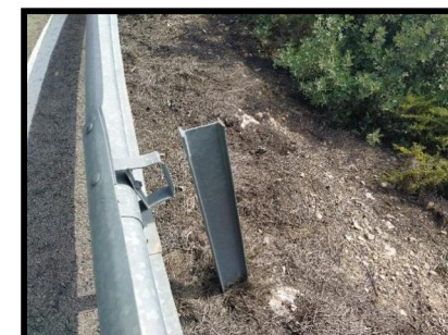
Ilustración 29: Defectos de instalación en barrera. Fuente: Elaboración propia.
