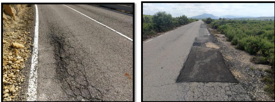
Ilustración 11: Estado del firme. Fuente: Elaboración propia.
