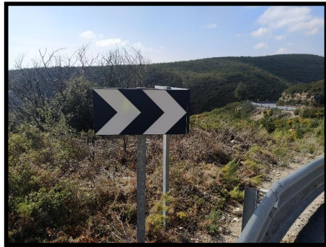
Ilustración 21: Panel de balizamiento existente. Fuente: Elaboración propia.
