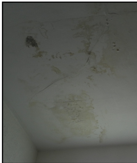
Gran humedad situada en el dormitorio principal
