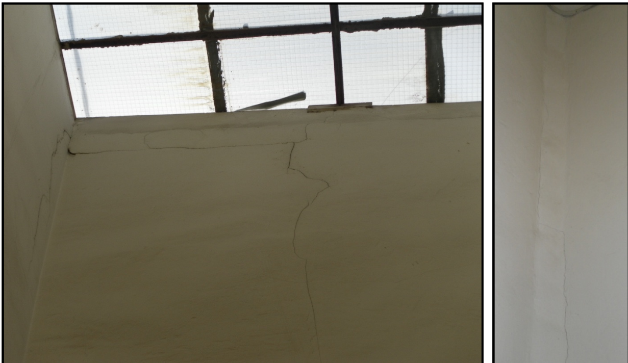
Fisuras en los espacios comunes, una bajo la claraboya, y la otra en una esquina de la escalera
