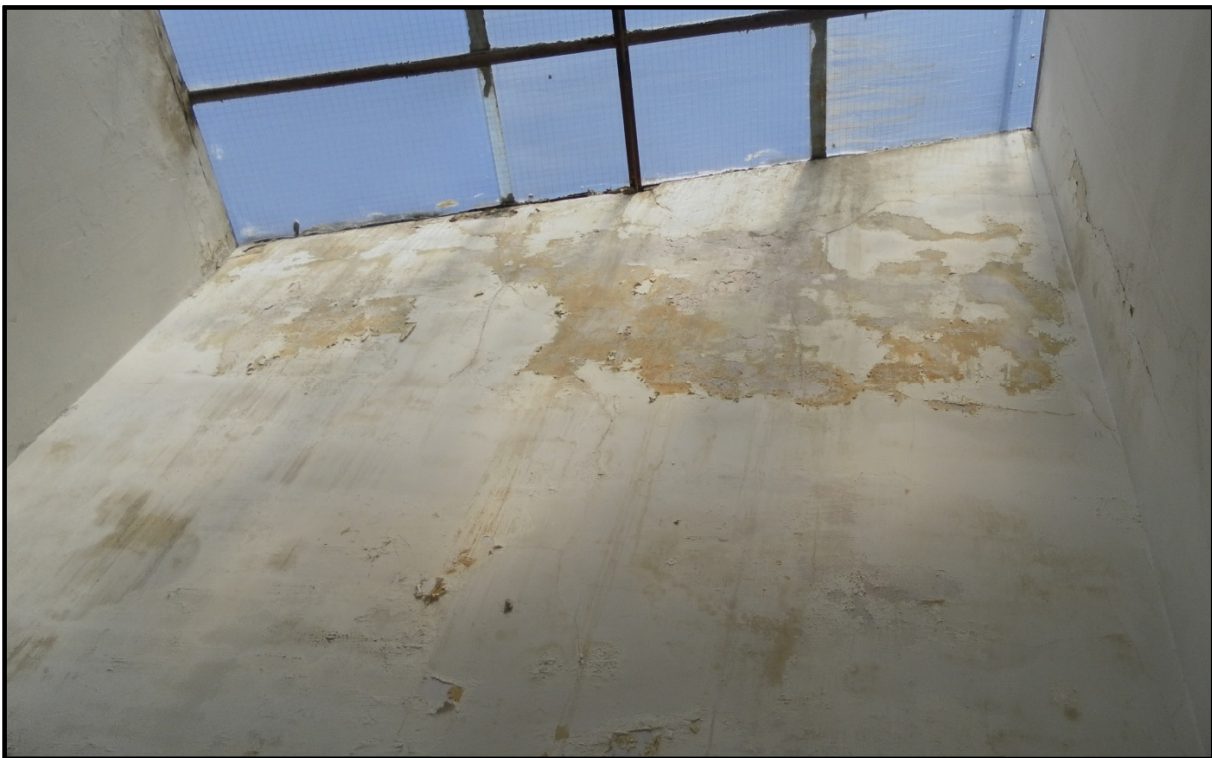
Humedades en todo el paramento con desprendimiento de pintura
