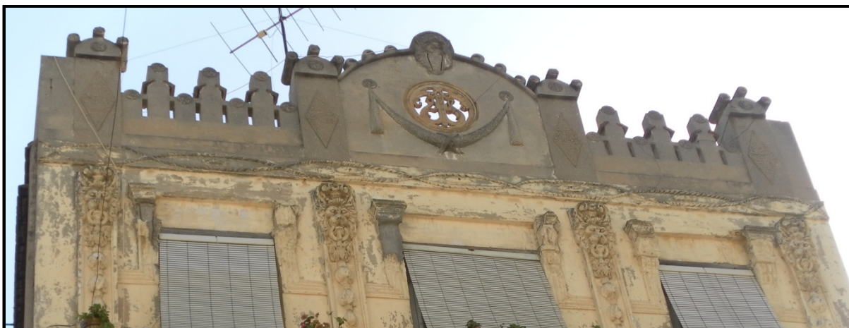
Desprendimiento en las molduras del peto y en las de alrededor de los balcones
