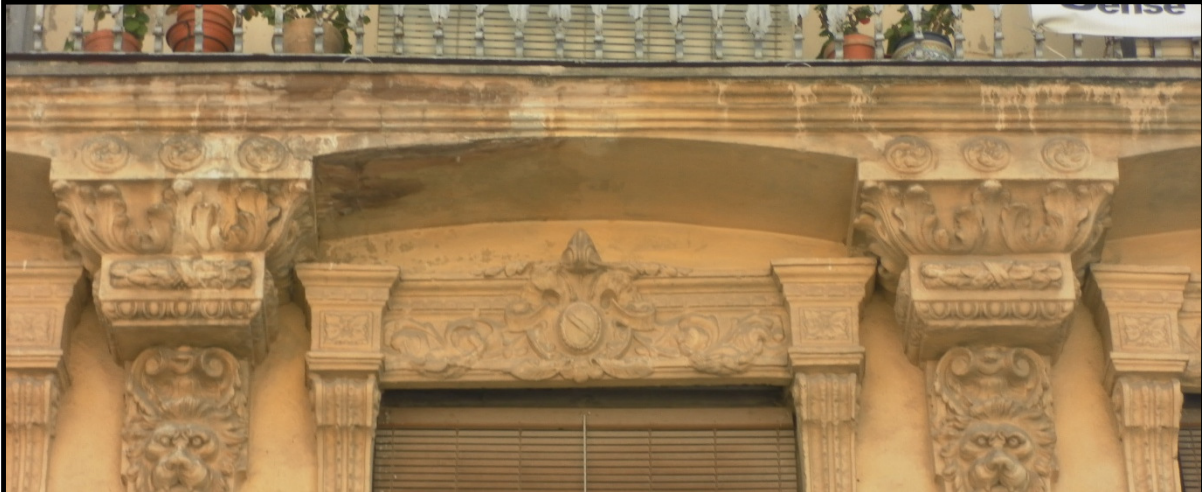
Zonas de la fachada con lavados
