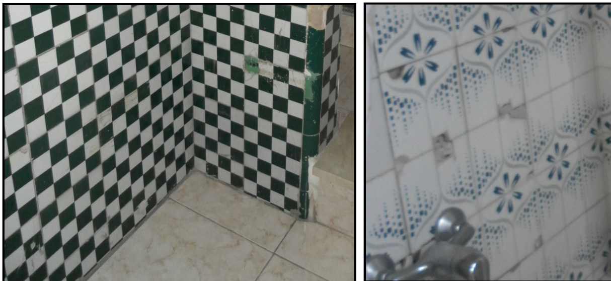
Picaduras en los azulejos de la entrada del edificio y del baño de la vivienda
