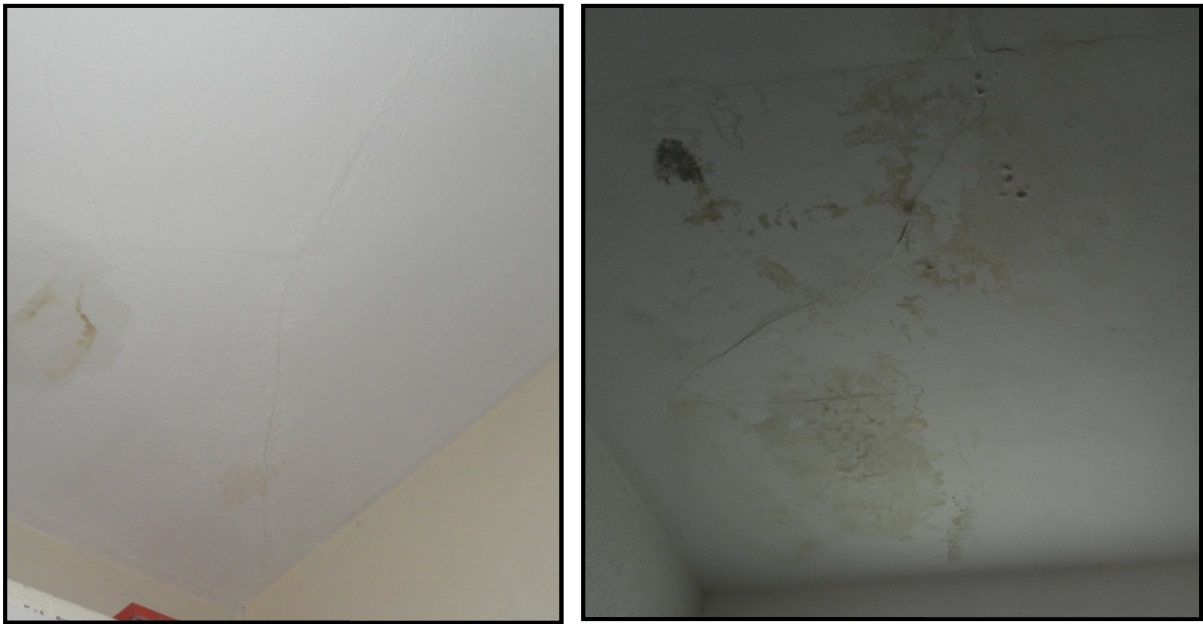
Fisuras situadas en las zonas en las que hay humedades
