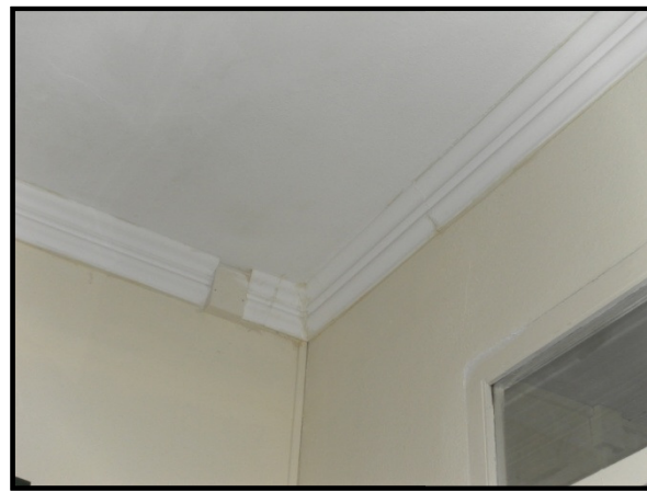
Unión del cielorraso con la tabiquería por la moldura
