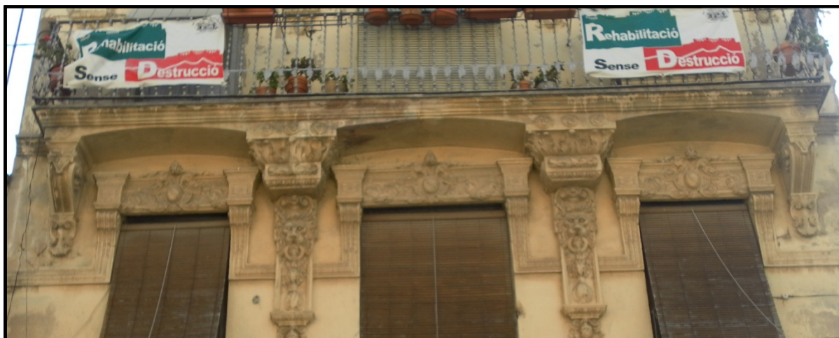
Ensuciamiento del canto del forjado de la segunda planta
