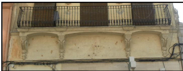
Fachada con desconchados de pintura
