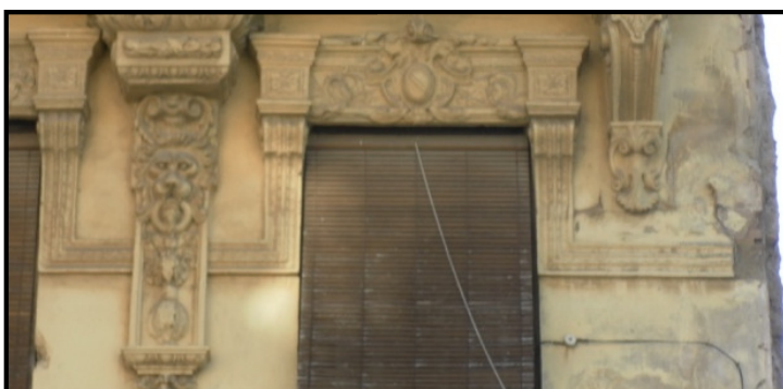
Desprendimientos en la primera planta
