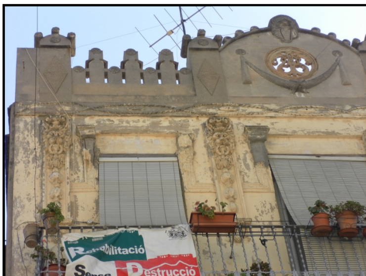
Desprendimientos en la segunda planta
