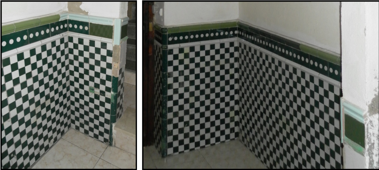
Caída y en algunos casos sustitución de las piezas.
