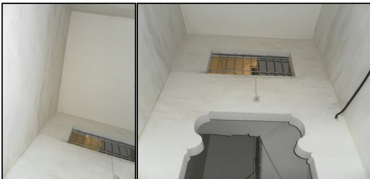
Ensuciamiento de las paredes del patio del edificio
