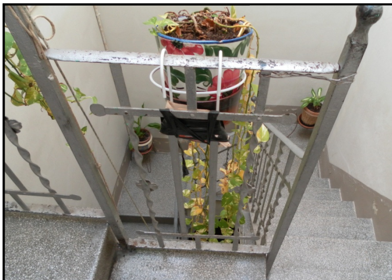
Oxidación y pérdida de la pintura de la barandilla
