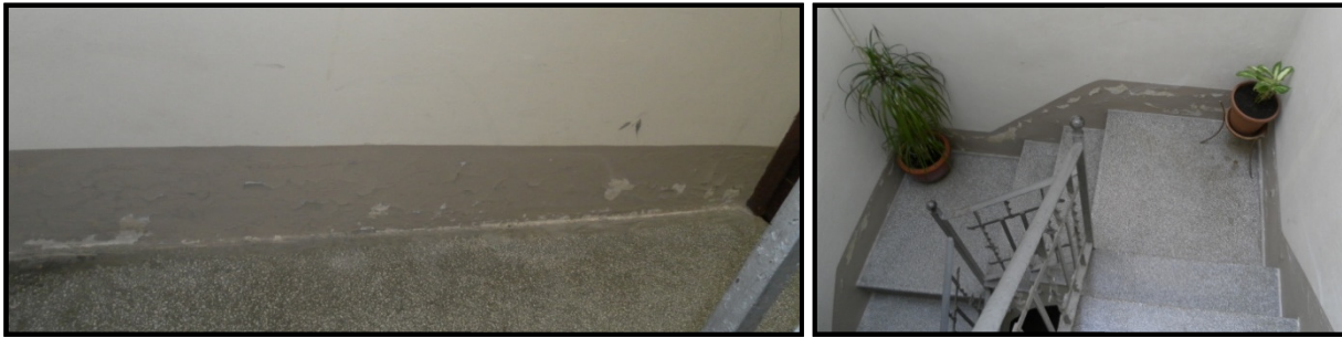
Desconchados en toda la zona de las escaleras
