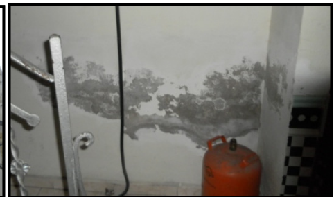
Desconchados de pintura del patio
