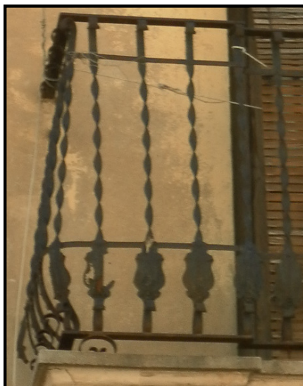
Pérdida del material por la corrosión
