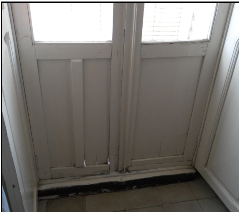
Falta de material en la zona inferior de la puerta debido al desgaste.
