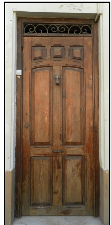
Desgaste debido al uso
