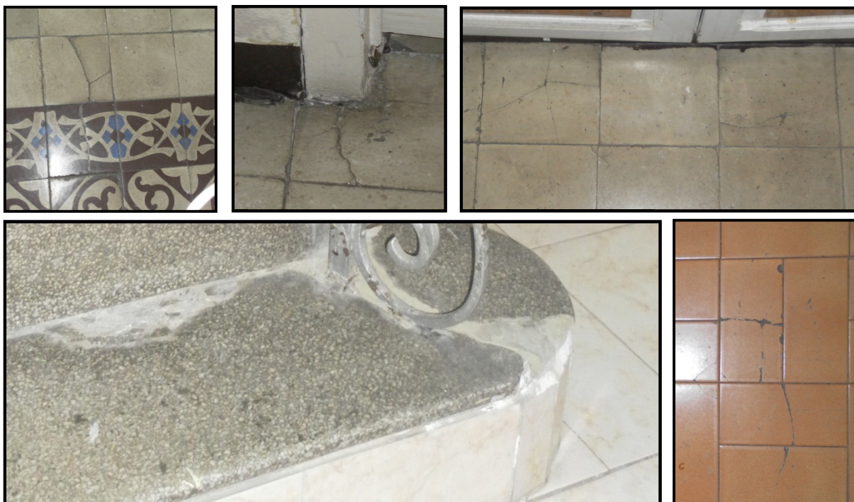
Ejemplos de algunas roturas de los pavimentos de la vivienda y de los escalones
