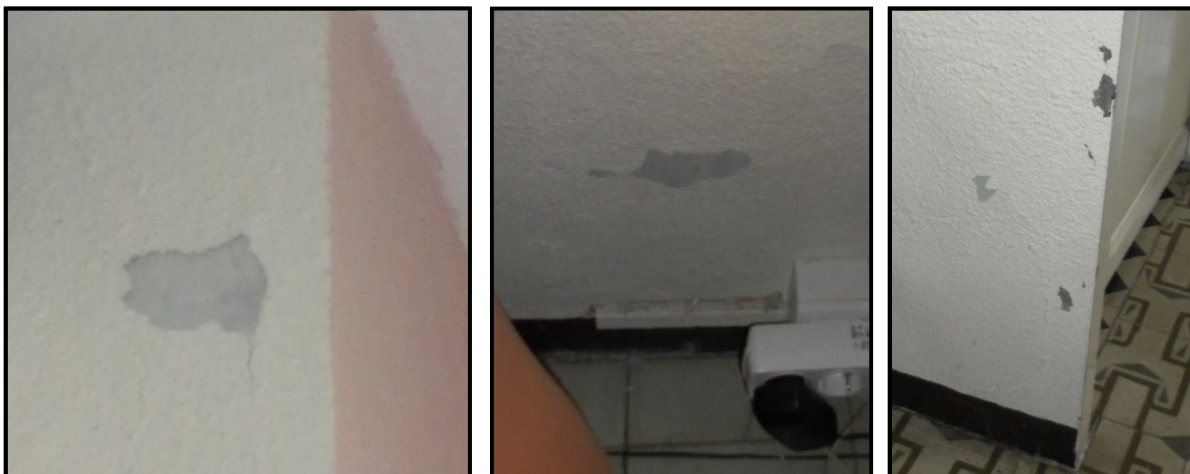
Desconchados situados en el pilar del dormitorio, en la sala de estar y en la entrada
