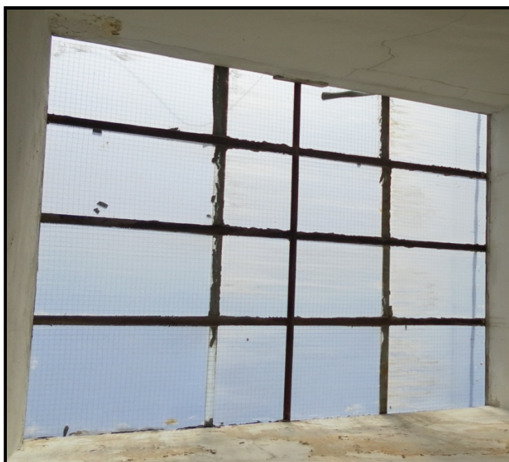
Oxidación de los montantes de la claraboya
