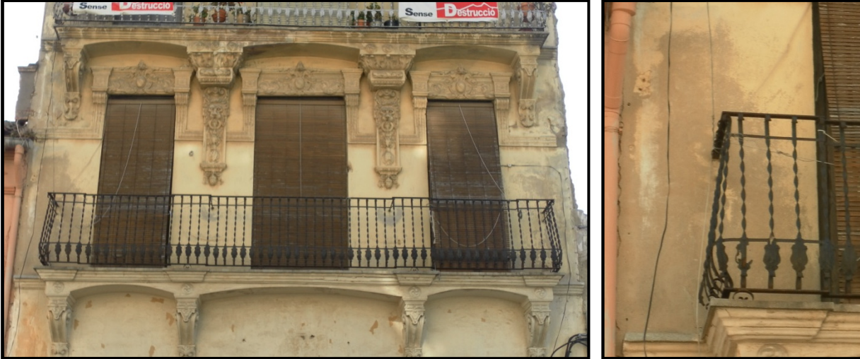
Localización de las exfoliaciones
