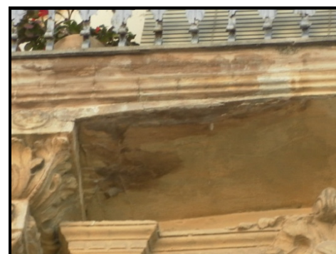
Pequeños desprendimientos en el forjado
