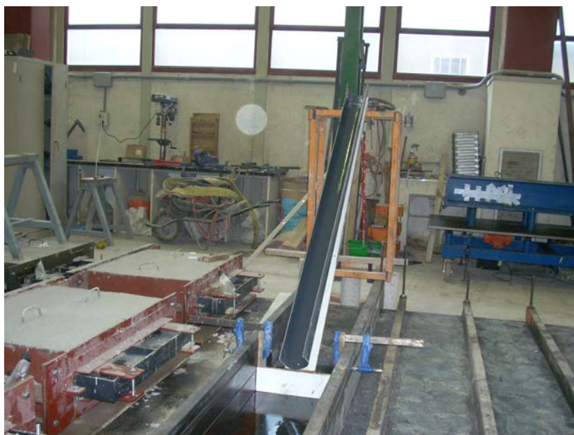
Figura 3.11 ESTRUCTURA DE VERTIDO PARA EL HORMIGÓN TRADICIONAL.
