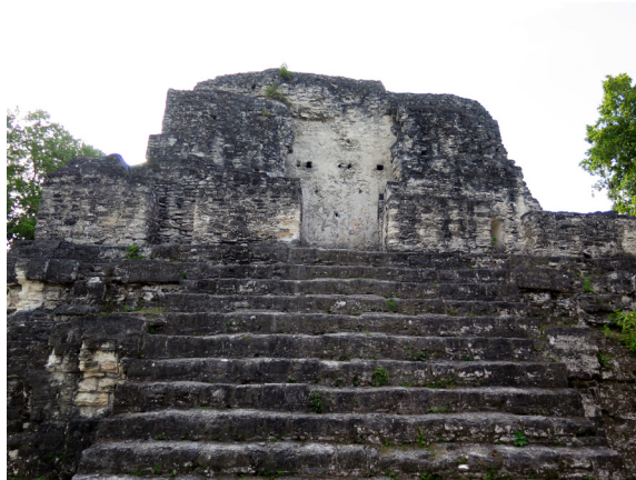
Figura 5. Templo 23 de la Acrópolis Norte de Tikal, en el que se ha derrumbado la totalidad de la bóveda de la crujía exterior y la zona central de la bóveda de la crujía central del edificio. Laura Gilbert, 2015.
