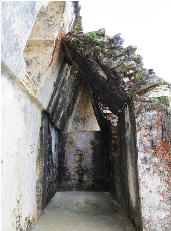
Figura 13. Vuelco como sólido rígido de una parte de la bóveda en la Casa D del Palacio de Palenque. Laura Gilabert, 2015.
