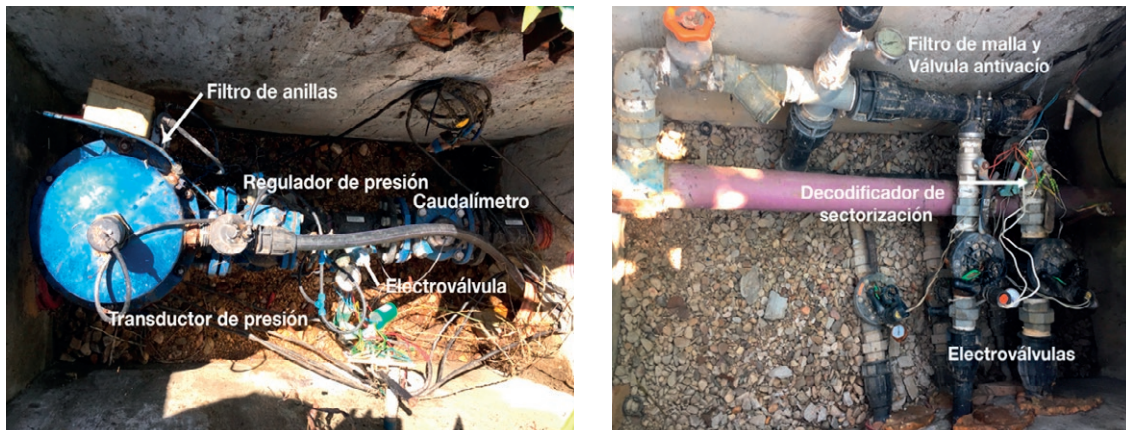
Figura 3 | Elementos hidráulicos de operación y control del riego.
