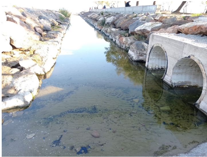
Figura 27. Aliviadero del colector de pluviales de la Línea 3 en Sagunto. Foto realizada 24/03/2021
