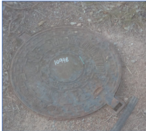
Figura 14. Tapa de alcantarillado con numeración 10948 posterior a la toma de datos de superficie en Puerto de Sagunto
