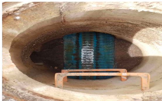
Figura 21. Colector de PEAD azul en línea de residuales, pozo 7431
