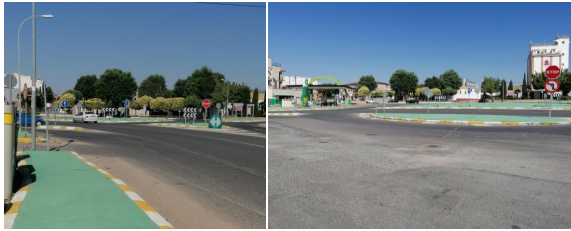
Figura 16: Señalización horizontal descolorida
