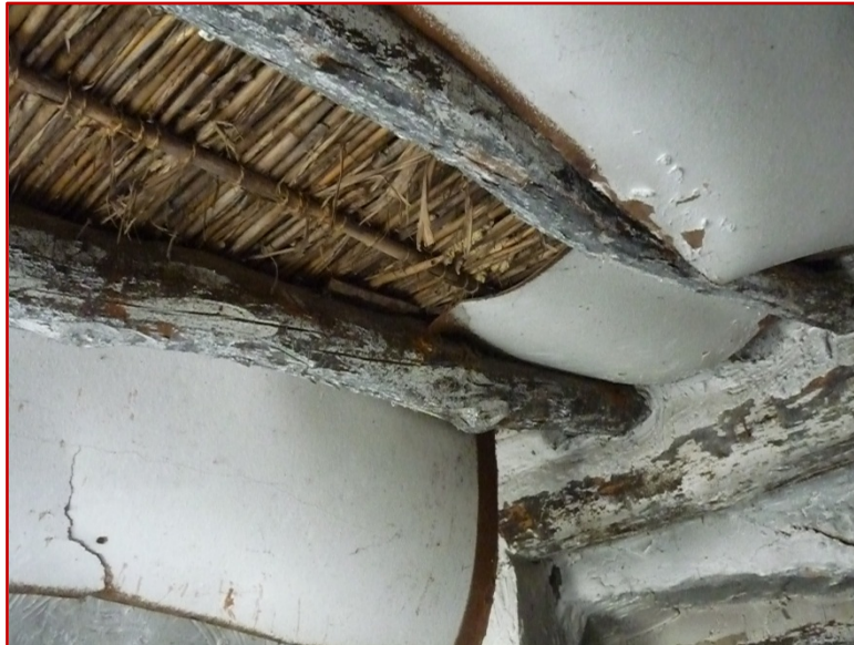
Fig. 6.7. Foto de la cubierta desde el interior de la casa. (Las laminas de chapa conglomerada se colocaron a posteriori para evitar filtraciones, sin éxito como se puede observar)
