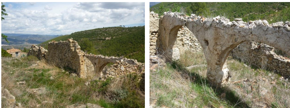
Vistas de los corrales en ruinas. (Aún se mantienen en pie las arcadas que servían de apoyo a la cubierta de la zona cerrada).
