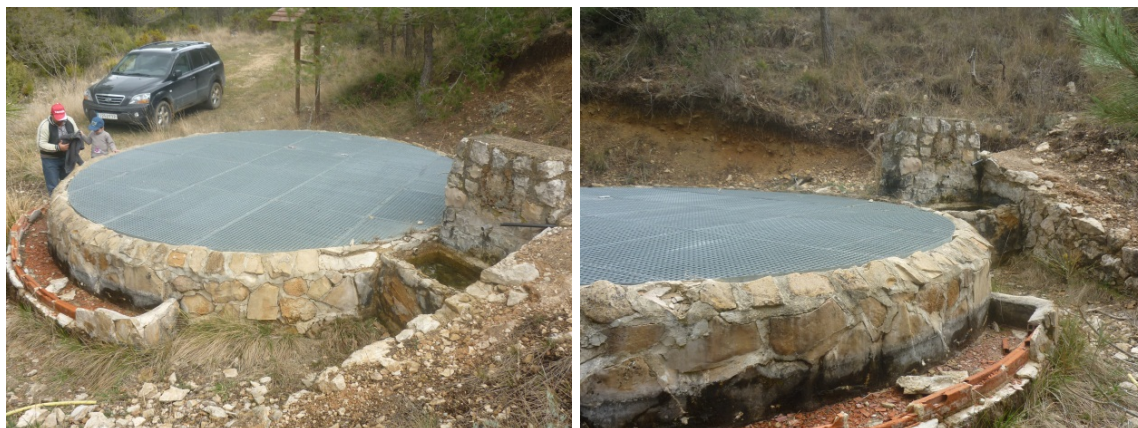
Depósito contra incendios adosado a la fuente de la Puerca.
