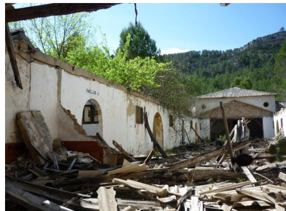
Ruinas del distribuidor interior. (originariamente cerrado con estructura de madera y placas de fibrocemento)
