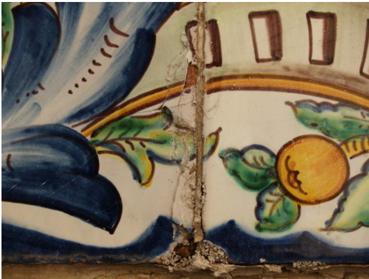
Figura 29. Testigos de sales en azulejos cerámicos. Avenida Blasco Ibáñez. Manises
