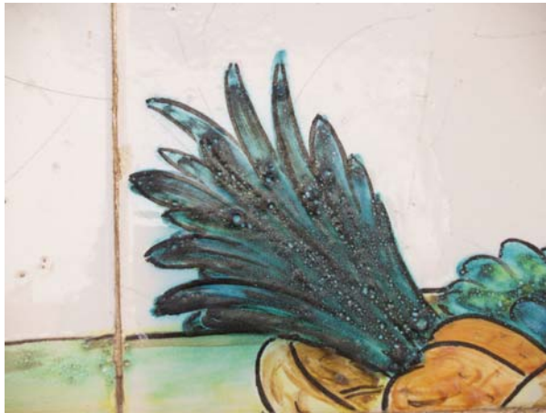
Figura 204. Acumulación del óxido de cobre.
