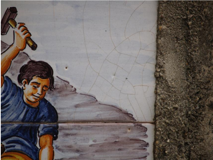
Figura 32. Agrietamiento en el barniz. Torrella
