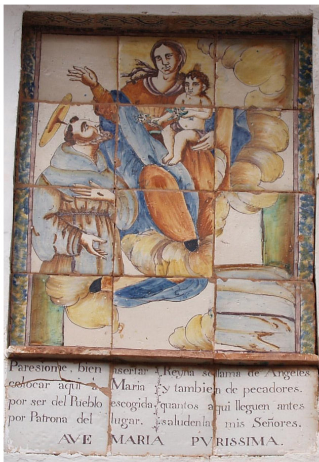
Figuras 30. Intervenciones inadecuadas sobre paneles cerámicos. Casinos.
