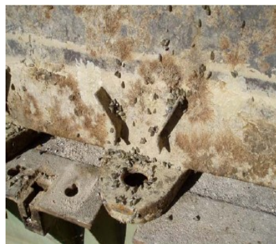
b) Instalación afectada
