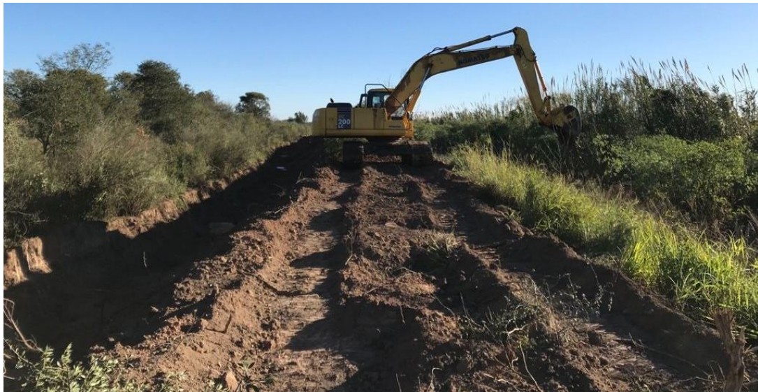
Figura 9: Trabajos de refuerzo de terraplenes de contención sobre el río Jesús María.
