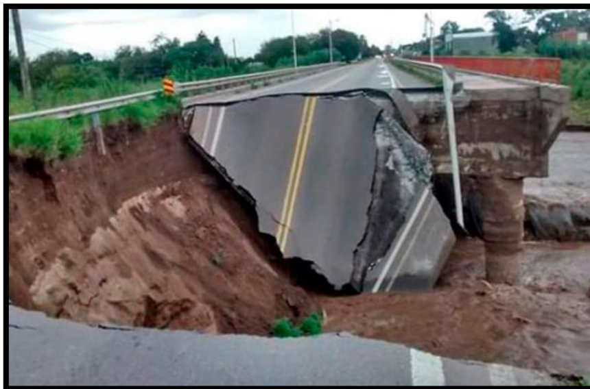
Figura 71: Rotura del estribo y losa de acceso al puente en ruta Nacional n°9 que vincula Jesús María con Sinsacate. Fuente: https://www.conclusion.com.ar/info-general/mas-danos-al-puente-que-une-jesus-maria-y-sinsacate/02/2015/
