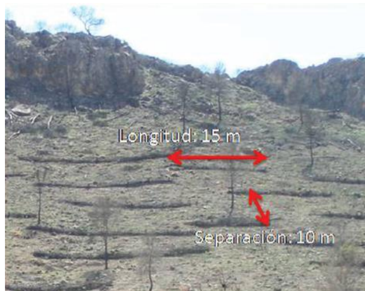
Figura 98: Fajinas. Criterios constructivos. Fuente: Manual para la realización de albarradas y fajinas para el control de la erosión en zonas forestales afectadas por el incendio de Hellín (Albacete) de 2012.
