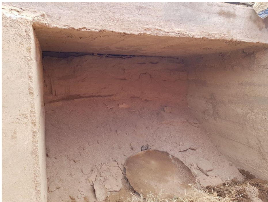
Figura 8: Obstrucción de puente-vado Cacho Caro, ubicado en el centro de la zona de color naranja de la Figura 1.
