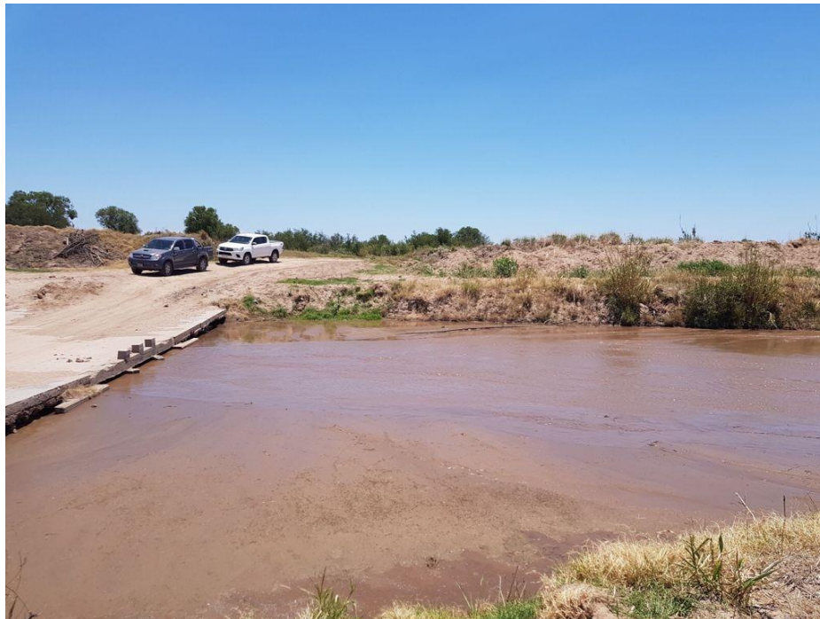
Figura 7: Obstrucción de puente-vado Cacho Caro, ubicado en el centro de la zona de color naranja de la Figura 1.
