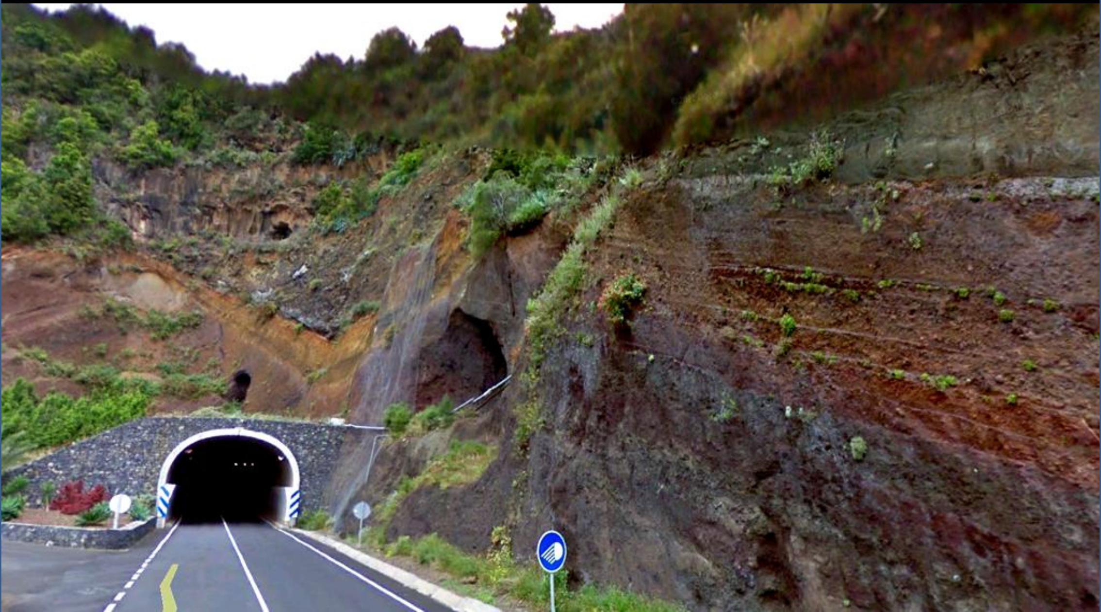
Túnel revestido, en los piroclastos, y coladas basálticas del volcán Taburiente. S de Roque, Centro N Isla de La Palma.
